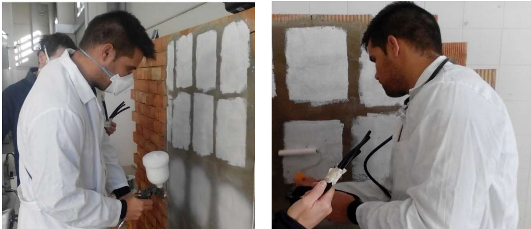
Figura 10. Trabajador durante la aplicación de la pintura y recubrimiento fotocatalítico mediante pistola (izq.) y derecha (drch.).
