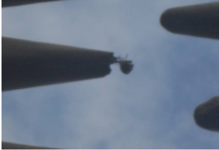
Imagen 5. Detalle de deterioro de la estructura. En la imagen parte de una de las clavijas internas de la obra. Bucaramanga. 2015. Fuente: El autor.
