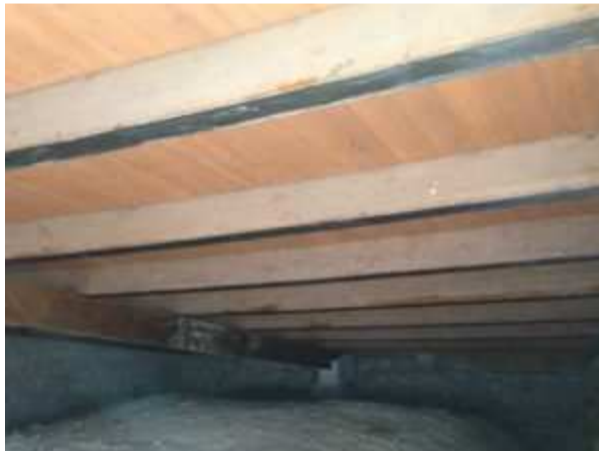
Figura 1.3. Refuerzo de vigas de madera con una lámina de CFRP. Fuente: https://www.olympus-frp.com/consolidamento-strutturale/adequamento-sismico/rinforzo-strutture-copertura-legno-un-castello-federicano-santagata-puglia-cfrp/rinforzo-a-flessione-travi-in-legno-con-cfrp-3/
