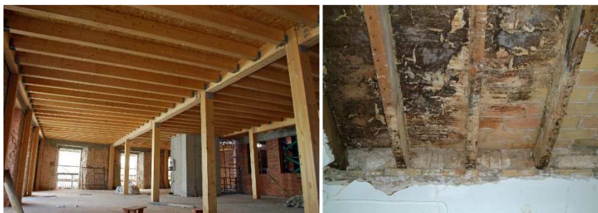
Figura 1.1. Estructuras de madera. Izq.: Sin deterioro. Der.: Con deterioro. Fuentes: http://www.trcestructuras.com/trabajo/edificio-de-viviendas-plaza-santa-ana/ . http://blog.simbolocalidad.com/servicio-tecnologico-de-inspeccion-y-diagnosic-de-madera-estructural .
