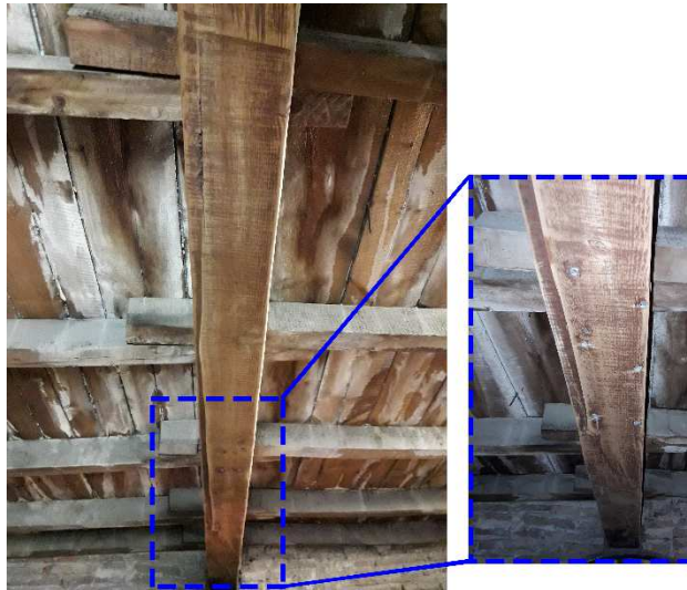
Figura 5.3. Imágenes del estado de la viga una vez fijada con las varillas de fibra de vidrio.
