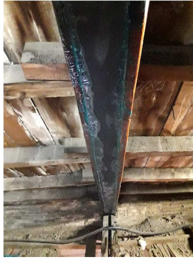
Figura 5.7. Estado de la viga tras la colocación de la lámina de CFRP.
