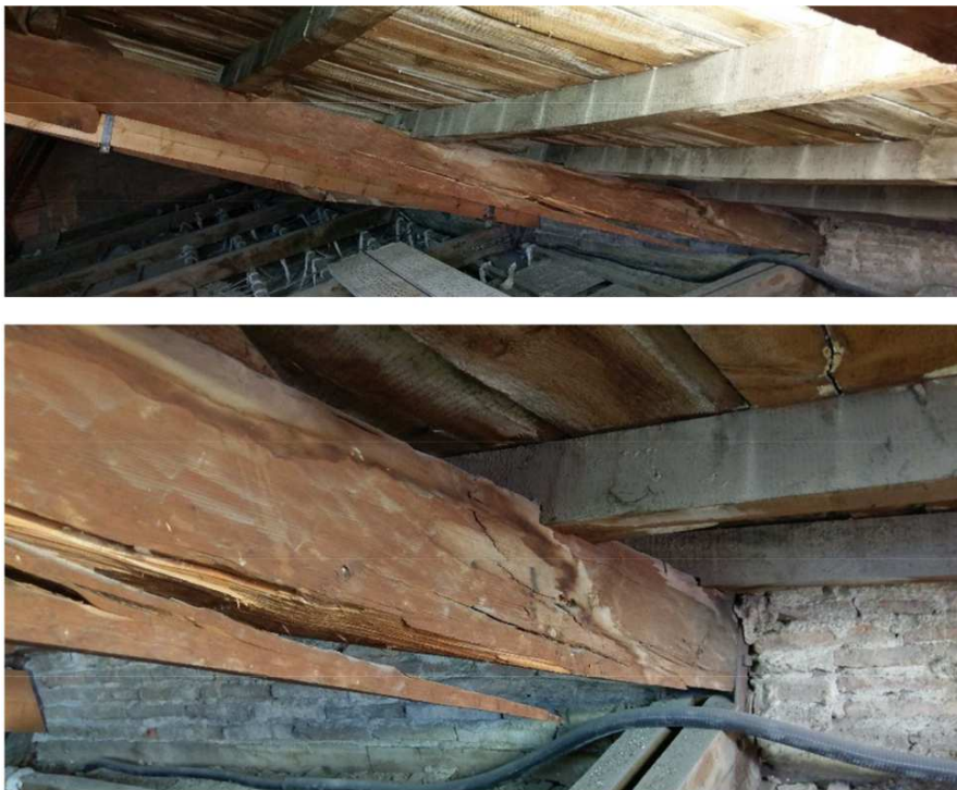
Figura 5.2. Imagen de la rotura del par de cubierta en el edificio de Capitanía. Arriba: Vista general. Abajo: Detalle de la rotura y la llegada del par al durmiente.
