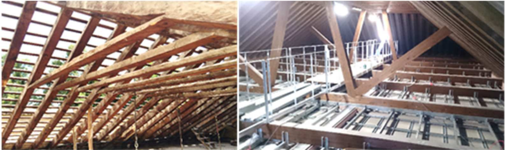
Figura 1.5. Cubierta de la Facultad de Derecho de la Universidad de Granada. Izq.: Estado anterior a la rehabilitación. Der.: Estado posterior a la rehabilitación.
