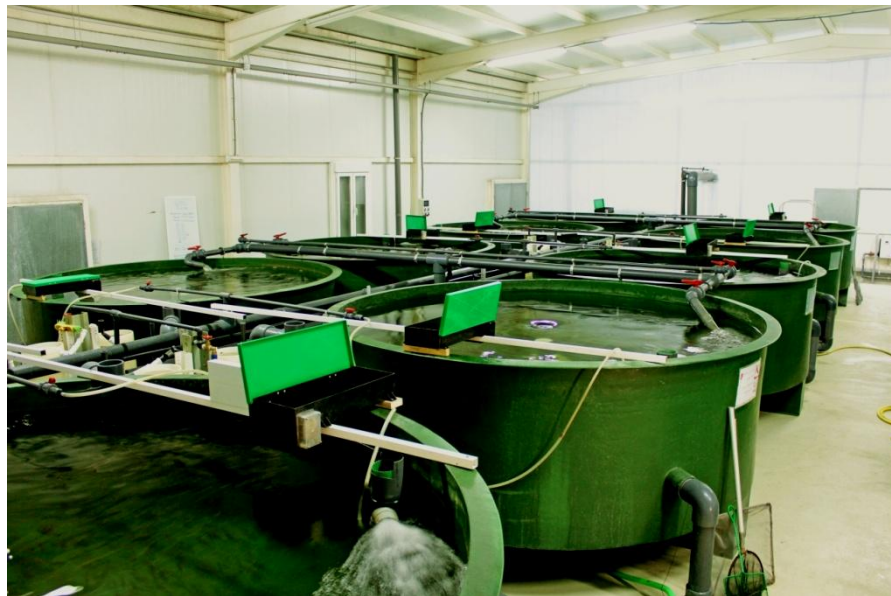
Figura 17. Instalación de sistema intensivo con sistema de recirculación.
