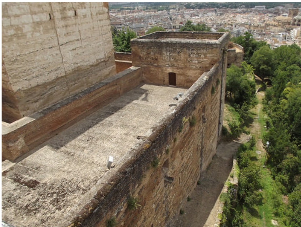
Ilustración 20 Salida del piso superior de la torre de los Hidalgos a la terraza que pudo haber sido un gran pajar
