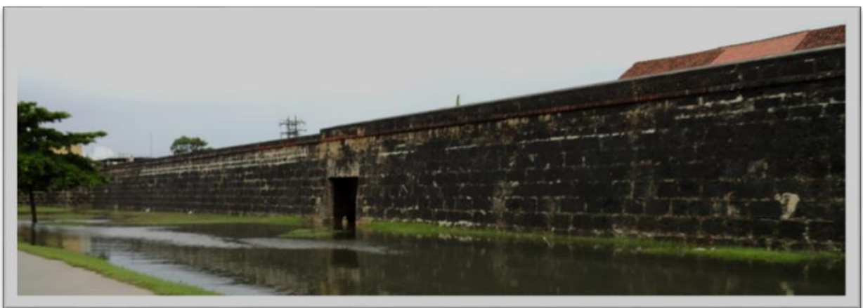
Ilustración 49. Cortina entre Baluartes de San Lucas y San Pedro Mártir en riesgo por inundaciones periódicas. 130
