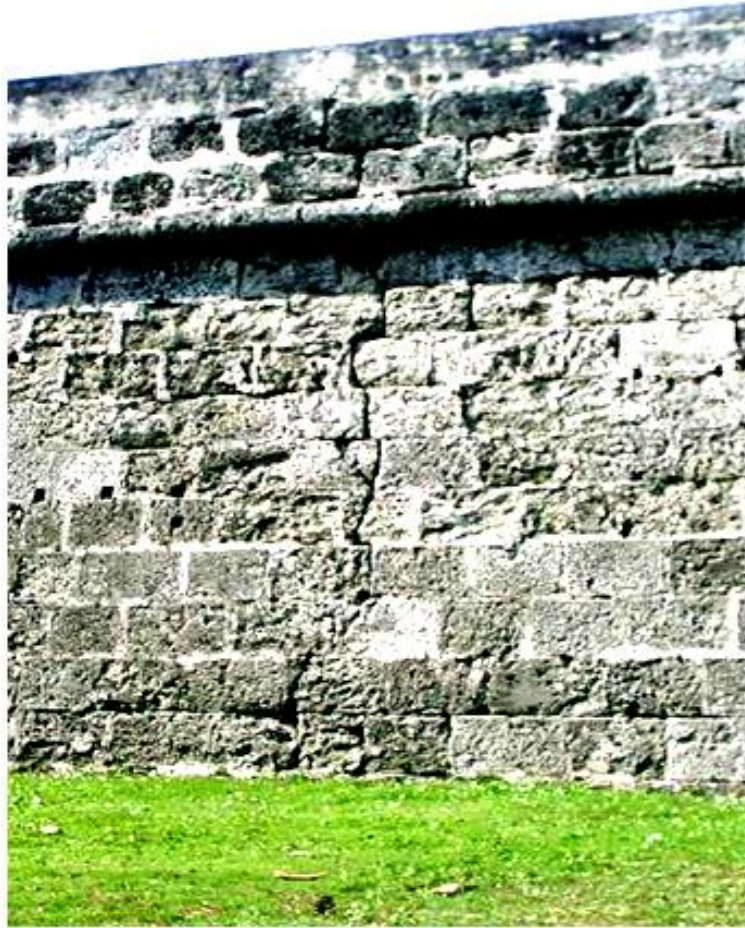
Ilustración 40. Grieta de antigua cortina entre Baluartes Santa Catalina y San Lucas 122
