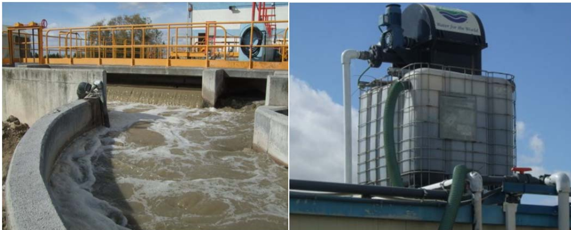
Figura 3.2: A la izquierda, canal de entrada a decantadores desde donde se bombea el agua, y a la derecha, tamiz rotatorio y depósito de acumulación de la planta experimental
