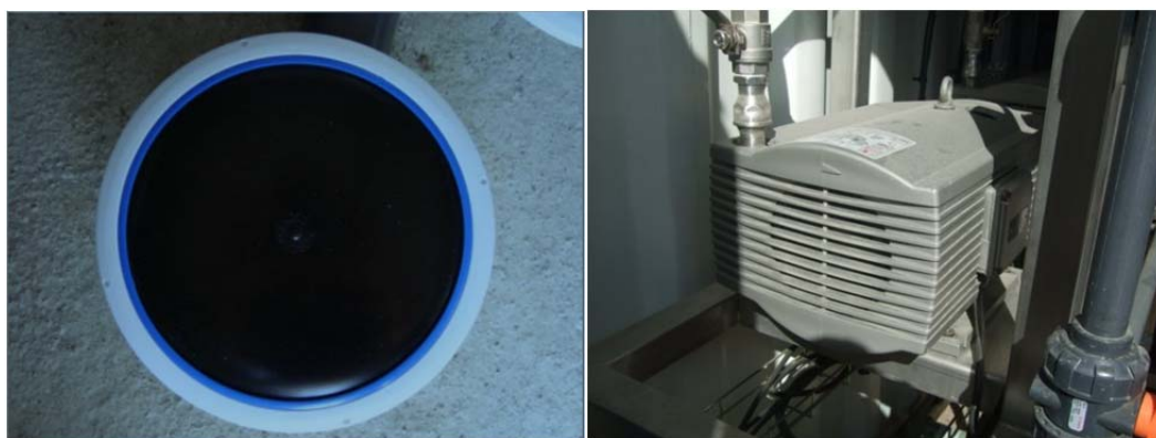
Figura 3.5: Difusor de aire ubicado en el reactor aireado (izquierda) y soplante utilizada en el proceso biológico (derecha)
