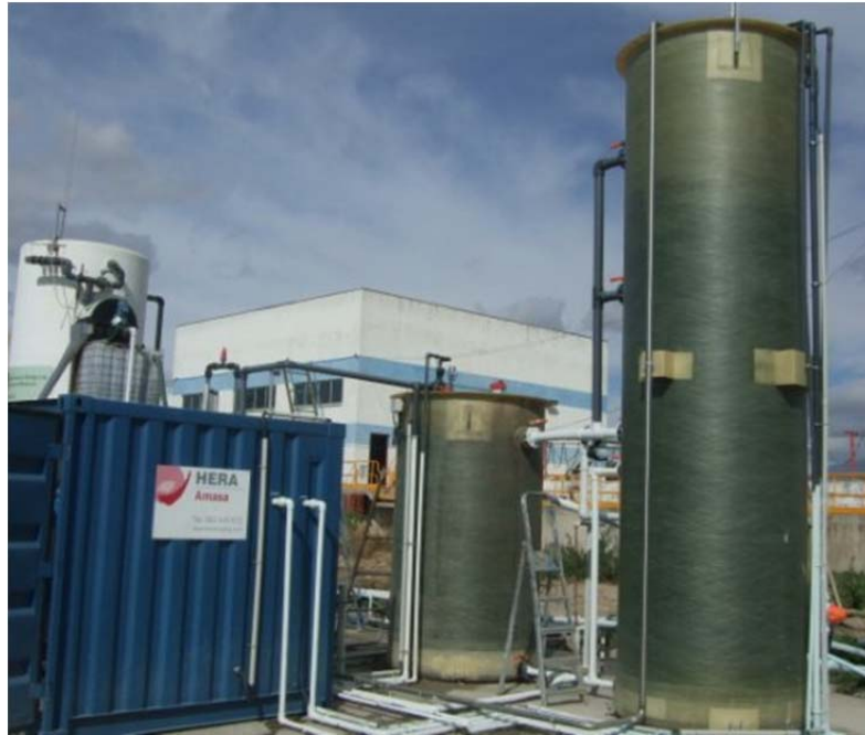
Figura 3.3: Instalación experimental con tecnología de microfiltración FS50 Kubota
