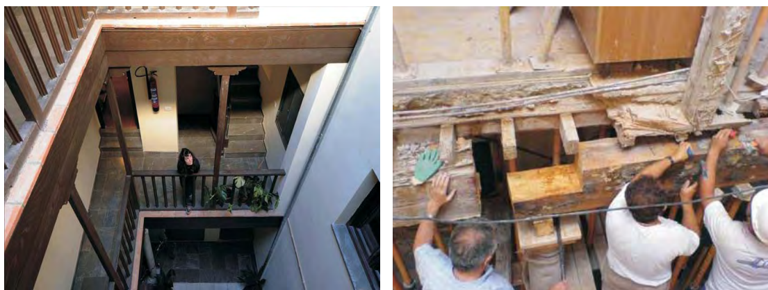
Fig. 05.06: Izquierda: Estado final de la rehabilitación en Cuesta de Marañas 5. Edificio adquirido por EPSA en 2002 cuya tramitación se hizo en esta primera etapa siendo el primero de los inmuebles de promoción pública entregados a sus inquilinos, que fueron elegidos mediante sorteo en 2007. Fuente: Fotografía de Mar Ruíz para el folleto encargado por la Oficina del ARC. Derecha: Obra de rehabilitación en el edificio de C / Carnero 4, actuación llevada a cabo mediante el programa de Rehabilitación Autonómica para zonas comunes y en el interior de alguna de sus viviendas (2006). ARC Albaicín. Fuente: elaboración propia.
