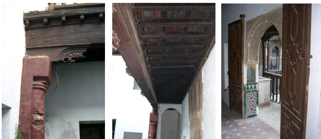
Izquierda: detalle de la pilastra de ladrillo, can morisco, viga y cabezas labradas del alfarje de la galería principal de la planta baja. Centro: detalle del alfarje de la galería de planta baja y al fondo arco de paso a la escalera para acceso a la galería alta. Derecha: estado actual del arco con yeserías, taca y zócalo de la galería alta. Todo ello objeto de las obras de restauración planteadas en el proyecto.
