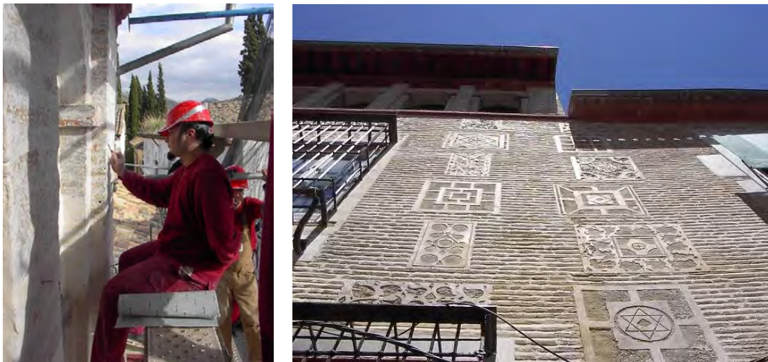
Trabajos de restauración de la fábrica de ladrillo y de los esgrafiados de la fachada a cuesta de San Gregorio. Resultado final
