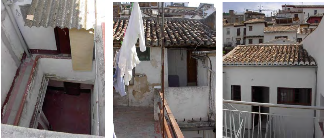
Izquierda. Estado previo a la intervención del patio principal y de la galería superior cubierta parcialmente con chapas de fibrocemento. Centro: Cuerpo de remate de la escalera con detalle del estado de conservación de la cubierta de teja. Derecha: Resultado final del cuerpo superior de viviendas y su acceso mediante la escalera abierta del patio .al fondo la ladera del Zenete.
