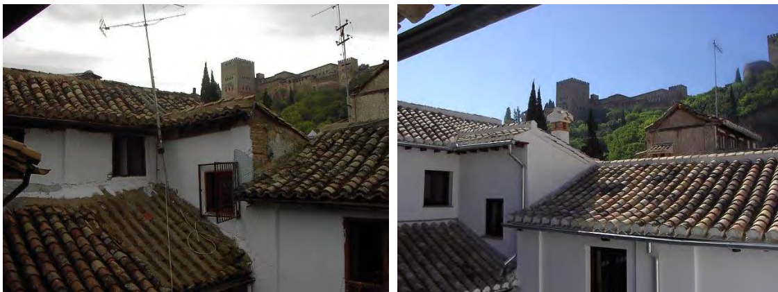
Estado previo (izquierda) y resultado final tras la rehabilitación de las cubiertas del inmueble de la C/ Zafra nº 8. Fotografías tomadas desde la galería de la planta segunda desde la que se disfruta de soleamiento y vistas de la Alhambra
