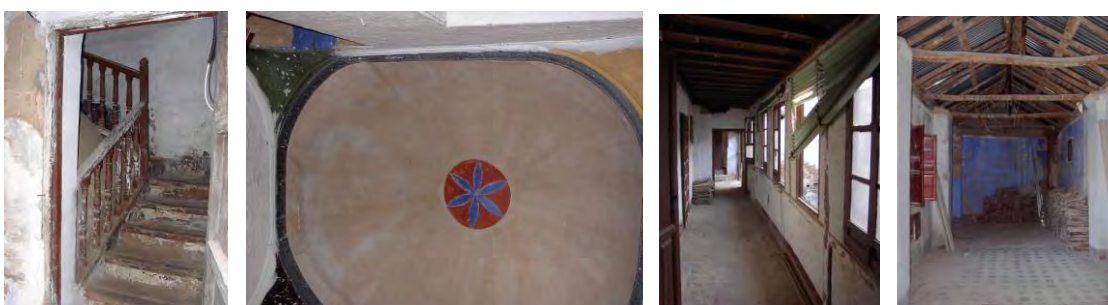
A la izquierda, arranque de escalera y bóveda de yeso sobre pechinas que cubre su caja. Al centro: Galerías Sur y que con la Oeste, el proyecto propone su recuperación. A la derecha, crujía ESTE que se planteaba remontar
