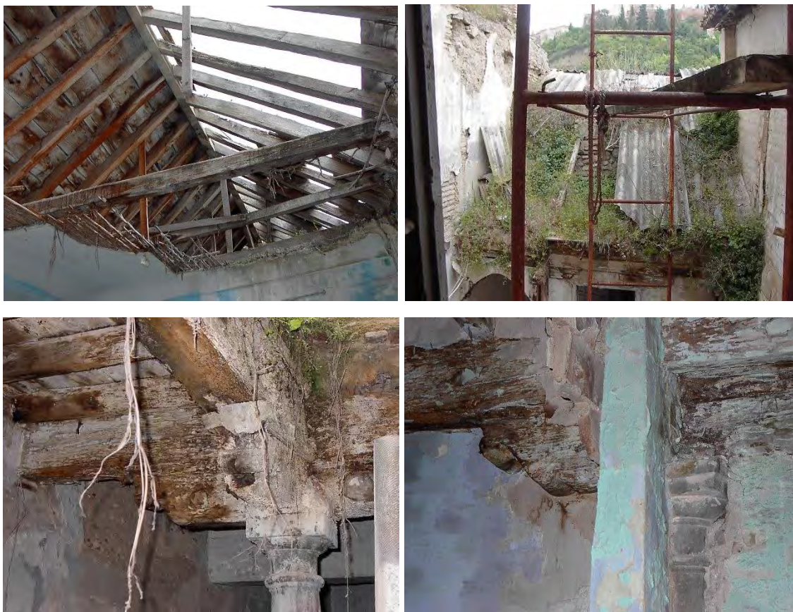
Arriba izquierda: Cubierta de la crujía lateral izquierda con pérdida de la teja y de la tablazón lo que ha causado su ruina y la filtración de agua de lluvia al resto de plantas. Arriba derecha: Faldón de cubierta de la primera crujía y su correspondiente galería hacia el patio, en la que tras la pérdida de teja y tablazón se cubrió con placas de fibrocemento también muy deterioradas entre las que creció la vegetación invasiva que se aprecia. Bajo esta mala cubierta se encontraban los elementos de mayor interés artístico, unos dañados e irrecuperables y otros sustraídos en diversos robos.
