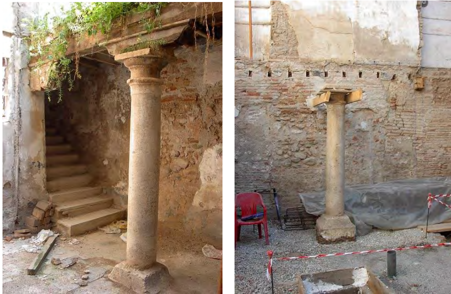
Estado previo de la galería demolida en planta baja en la que se aprecia la vegetación que cubre los restos arruinados, se aprecia también, junto a la escalera, el can que fue robado. A la derecha la columna sola y los mechinales de las viguetas demolidas de esta galería en ruinas.
