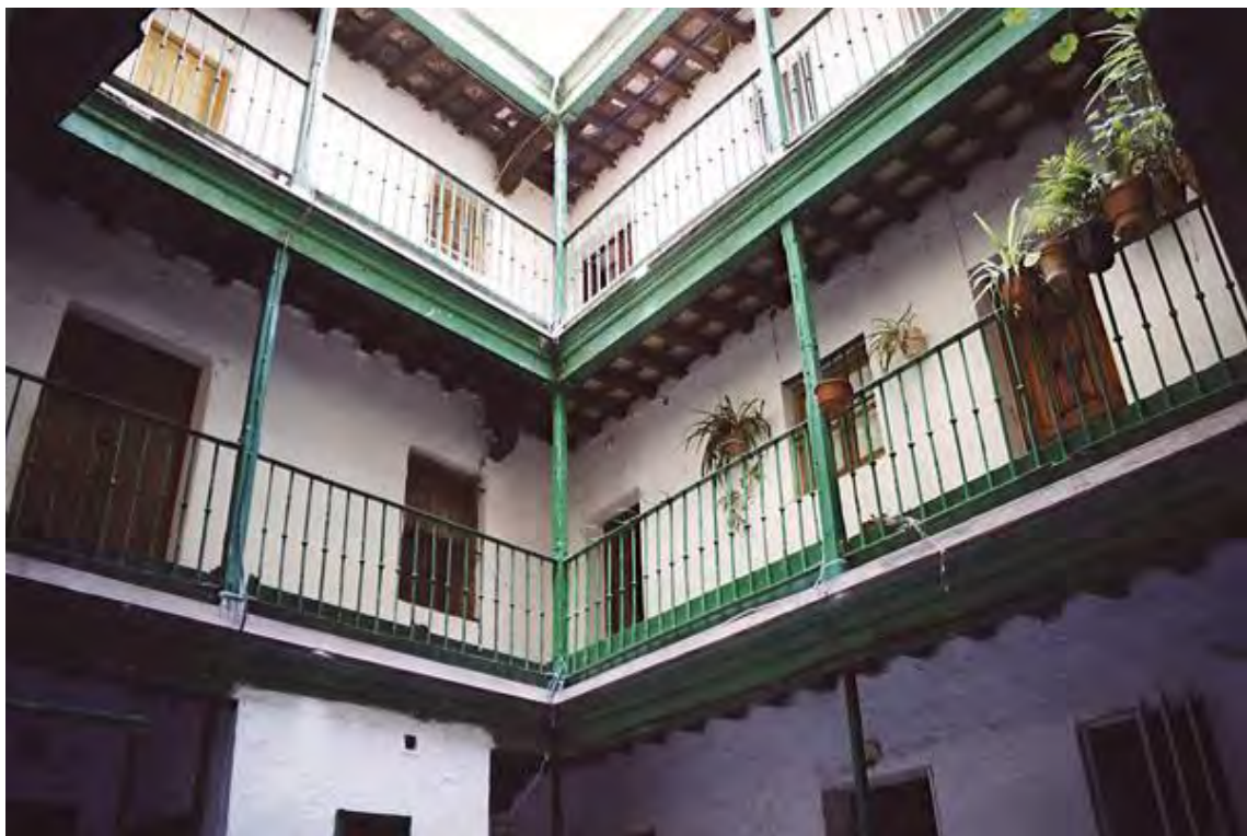
Fig.4.3.08: Rehabilitación de 27 viviendas en la Casa Juan Paje. Casco Histórico de Cádiz. Fuente: www.juntadeandalucia.es/avra/opencms/areas/Rehabilitacion/seleccion_actuaciones_centrosHistoricos/Cadiz.html .
