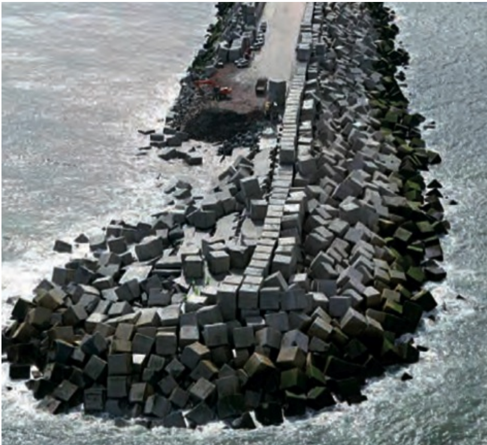
Figura 1.1: Daño en el dique en talud del Puerto de Gijón producido por una tormenta durante su ejecución.
