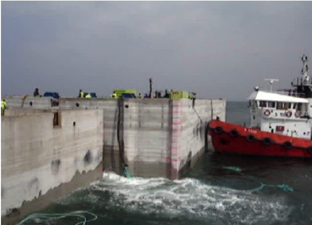
Figura 4.22: Hundimiento del cajón.
