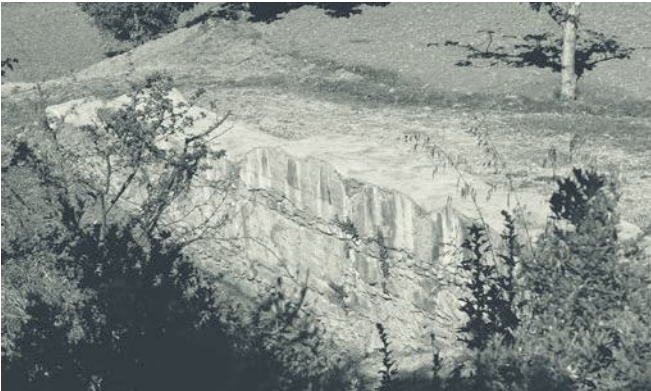
Restos de los muros de contención que separaban las huertas del Generalife.
