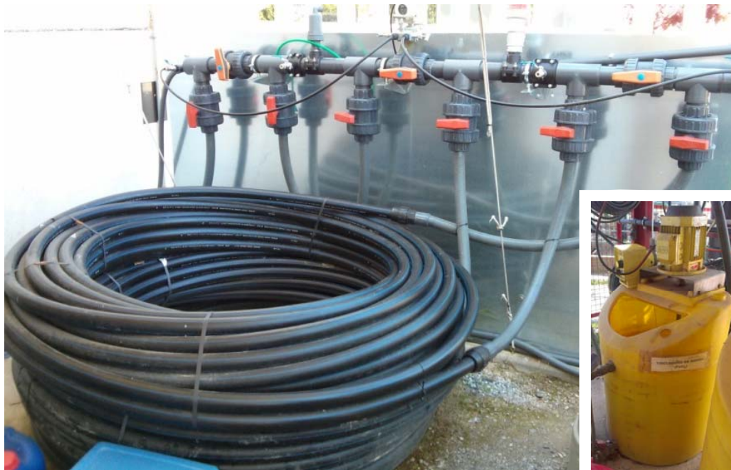
Figura 13. Sistema de coagulación-floculación hidráulica.
