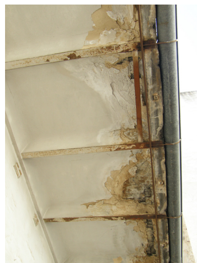
Imagen 8 | Vista de formación de voladizo con viguetas metálicas de ala estrecha y losa armada con alambrea. Fachada posterior Gran Vía 27. Foto: Roser Martínez Ramos
