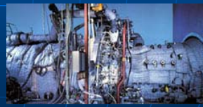
TURBINA DE VAPOR
