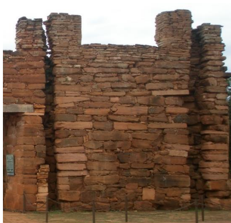
Fig. 41. Muro interno de la iglesia de San Ignacio Miní (Argentina). En su fábrica se puede apreciar el espacio en el que irían colocados los horcones.
