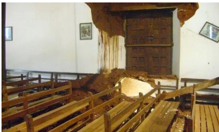
Fig. 12. Destrozos provocados por la lluvia en 2014.
