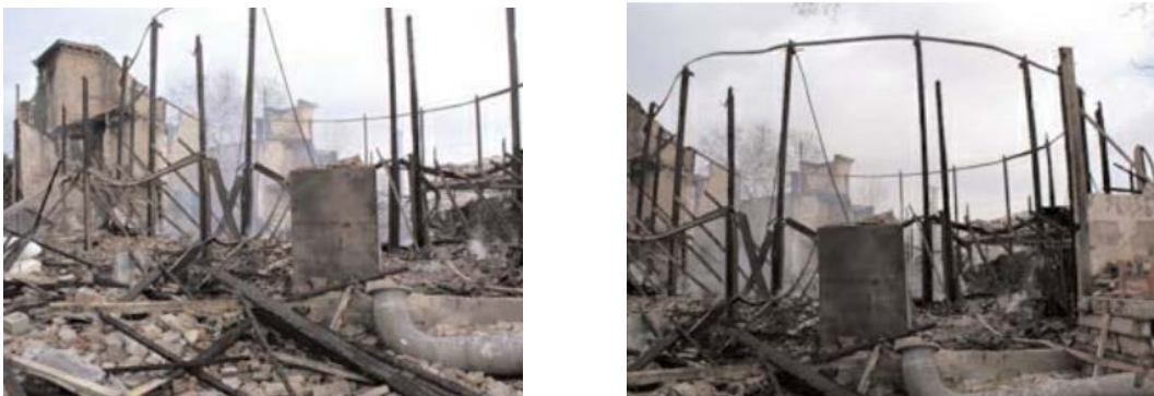
Figura 122. Estado en el que quedó el Teatro Circo Apolo, tras el incendio del año 2005. Obtenido de: https://www.vilanova.cat/doc/doc_31677894_1.pdf
