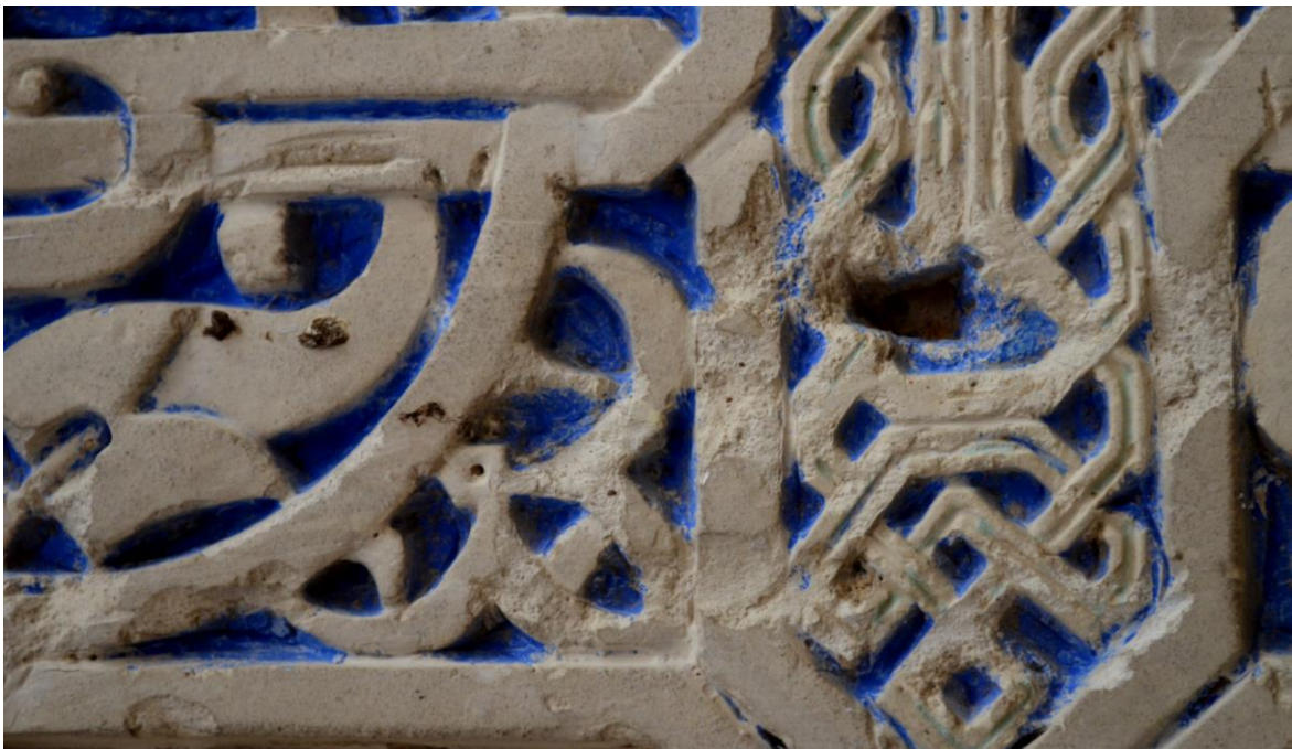
Figura 152. Detalle Remate de la puerta pequeña o escape en la que se detecta un clavo de grandes dimensiones, probablemente como refuerzo de adhesión de la placa.
