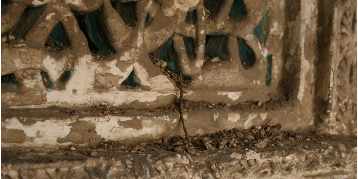
Figura 156. Detalle de la acumulación de suciedad y restos de anidación en la parte inferior de las celosías.
