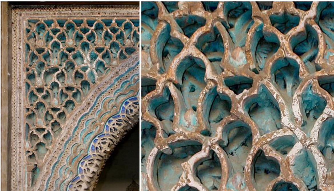
Figura 142. Albanega izquierda de la puerta de acceso al Salón del Techo de Carlos V. Obsérvese la presencia de una decoración inferior muy dañada debajo de la decoración de sebka superpuesta. Derecha. Detalle de la misma albanega.
