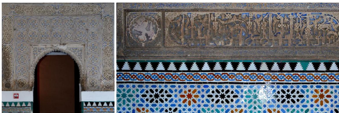
Figura 147. Detalle de las zonas donde se aprecia la presencia de humedad en diferentes zonas del paramento norte.
