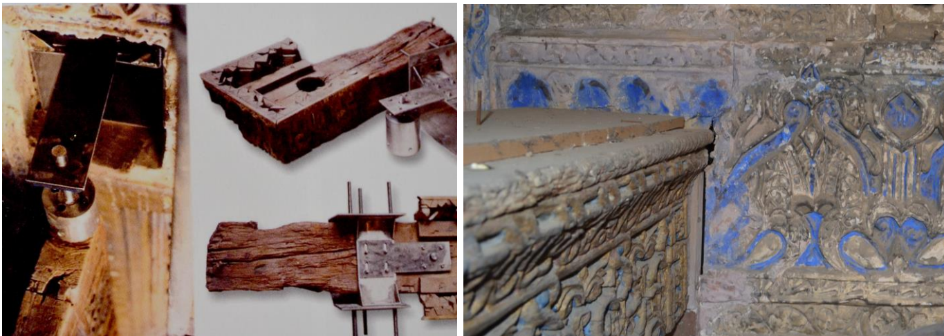
Figura 159. Izquierda. Imagen de la sustitución del sistema de giro. Imagen extraída (Fernández Aguilera, 2012, p. 145). Derecha. Imagen actual de la decoración de yesería de esa zona.
