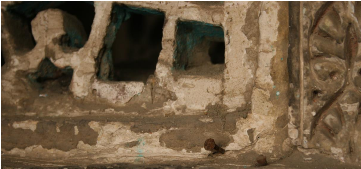
Figura 151. Detalle zona inferior de las celosías en los que se localizan dos clavos de pequeñas dimensiones.
