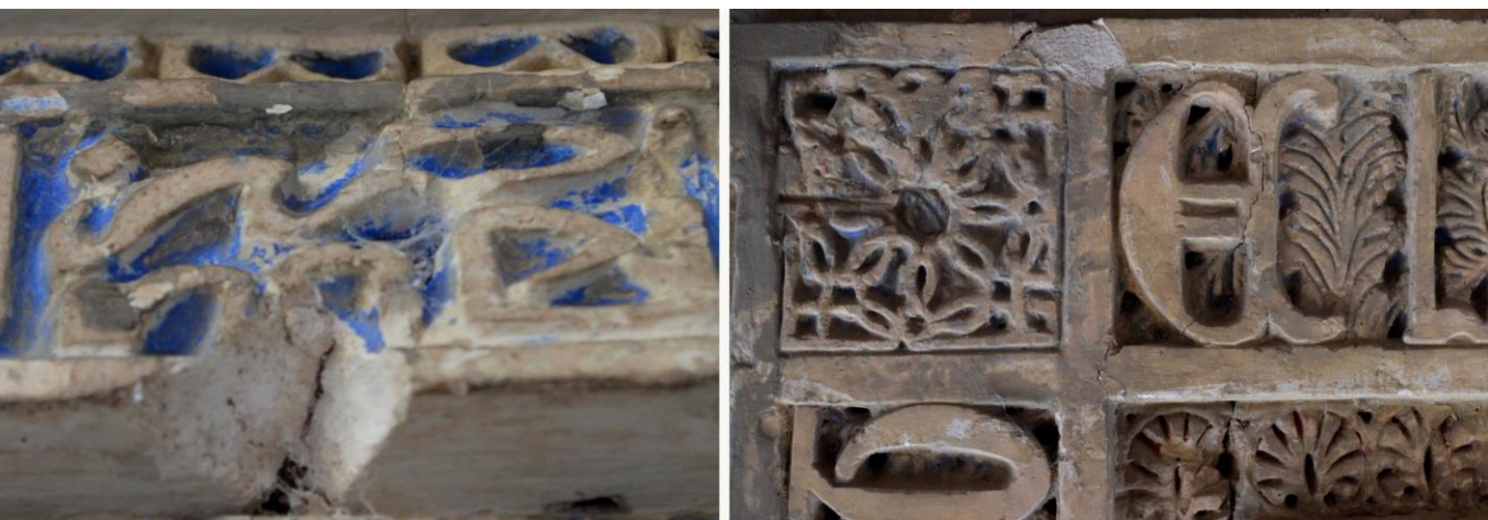
Figura 158. Detalle de faltas en el paramento.
