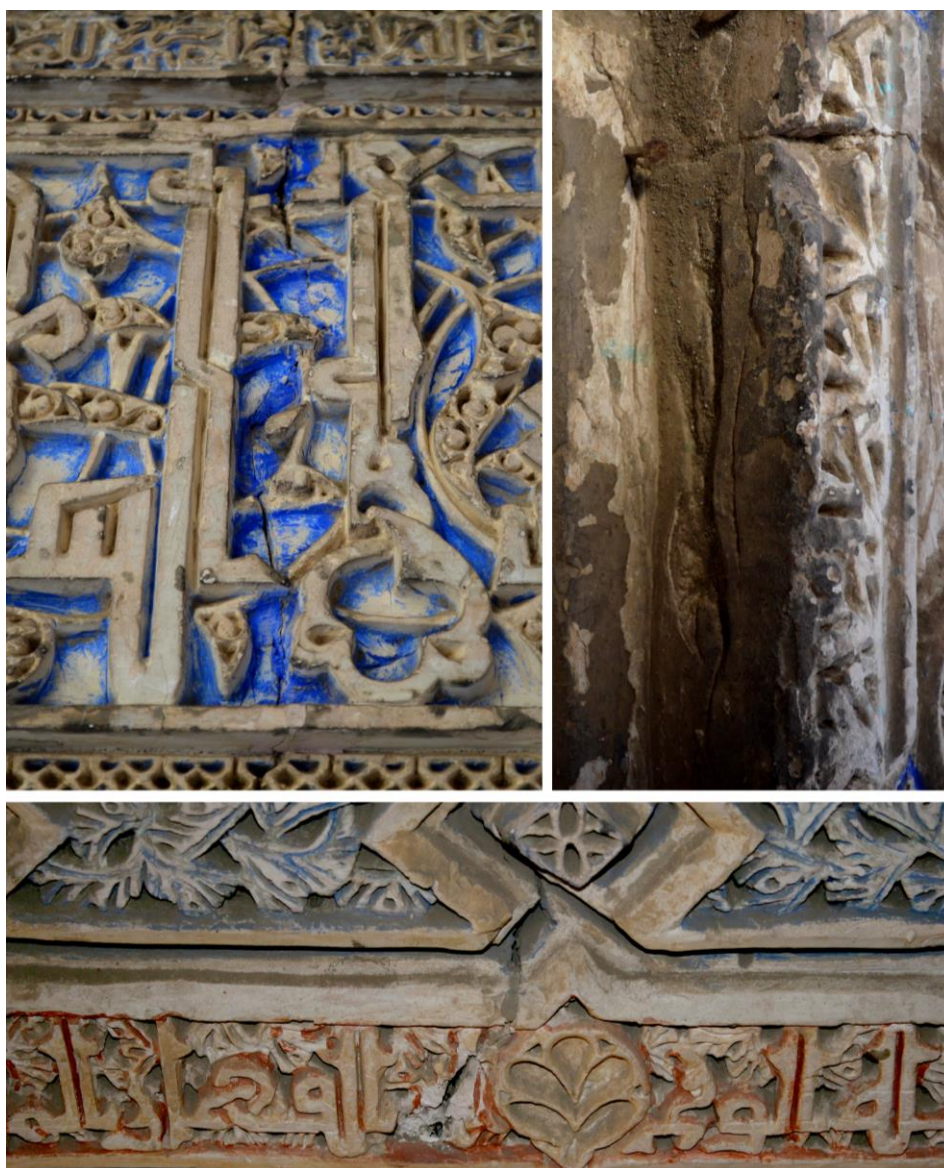
Fig. 149. Imágenes de detalle de diferentes grietas/fisuras detectadas en el paramento. Izquierda superior. Bandas epigráficas. Derecha superior. Borde celosías. Inferior. Zona del friso superior, cartela epigráfica.
