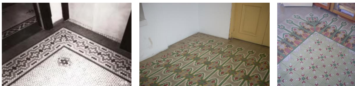
Figura 3.17.- Diseño de piso de la demolida Casa Valera en Santo Domingo y de las viviendas de influencia Art Decó en Santiago de Cuba. Foto (1) tomada de: Gustavo Luis Moré: Historias para la construcción de la arquitectura dominicana, 1492-2008 523
