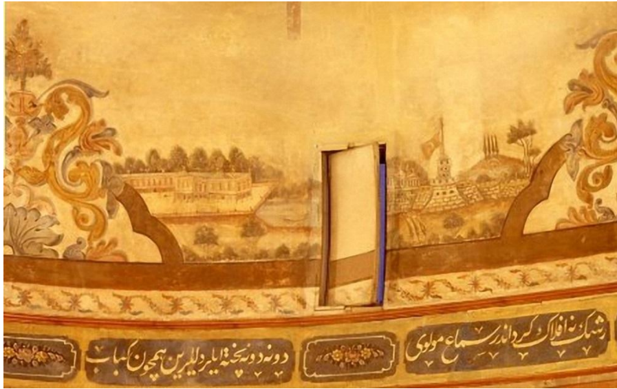
Fig. 72: Detalle de la decoración de la parte más inferior de la bóveda y puerta en la bóveda. (Fuente: CIERA)
