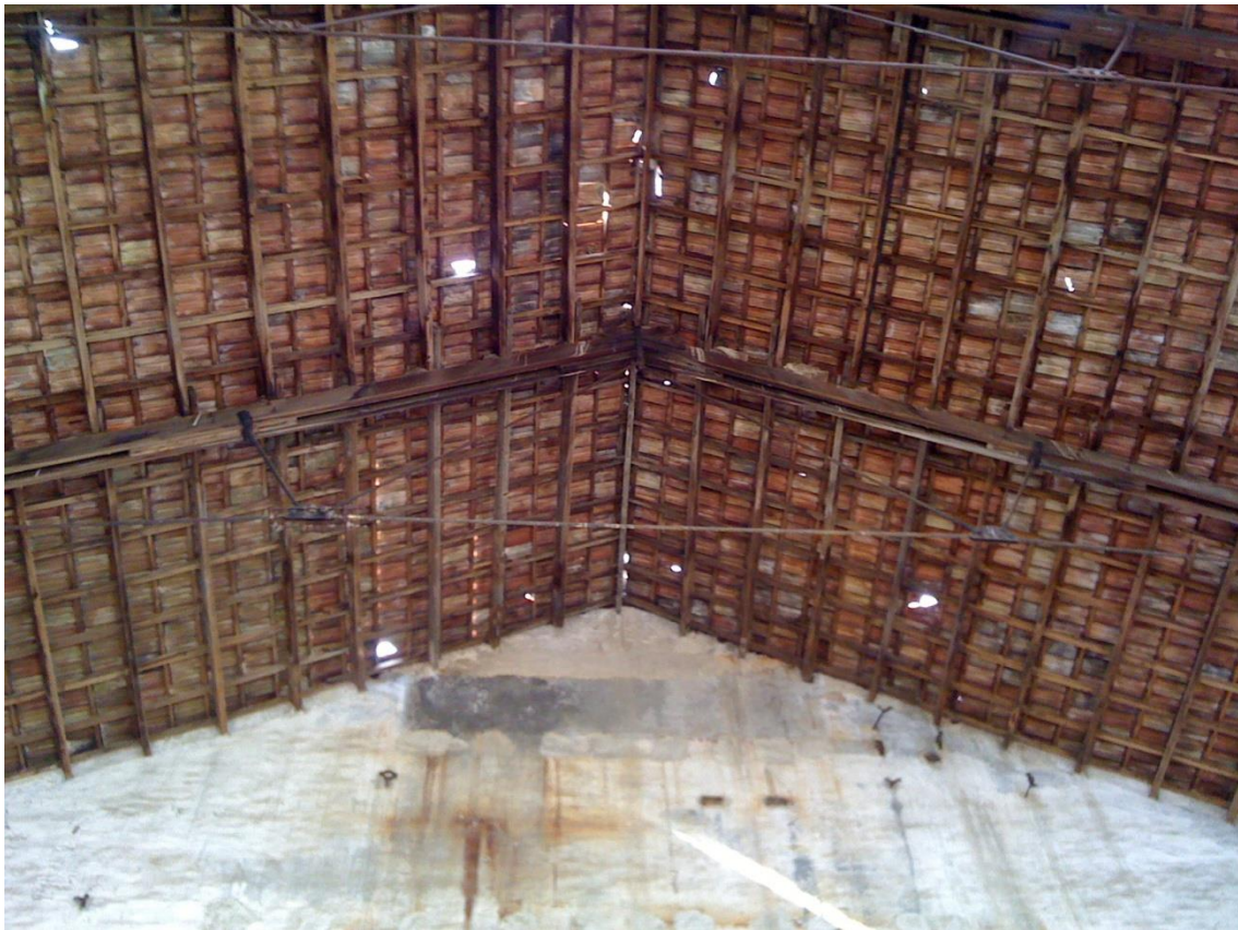
Figura 27. Estado de la cubierta de la nave de generadores en julio de 2009. Fuente: Elaboración propia.
