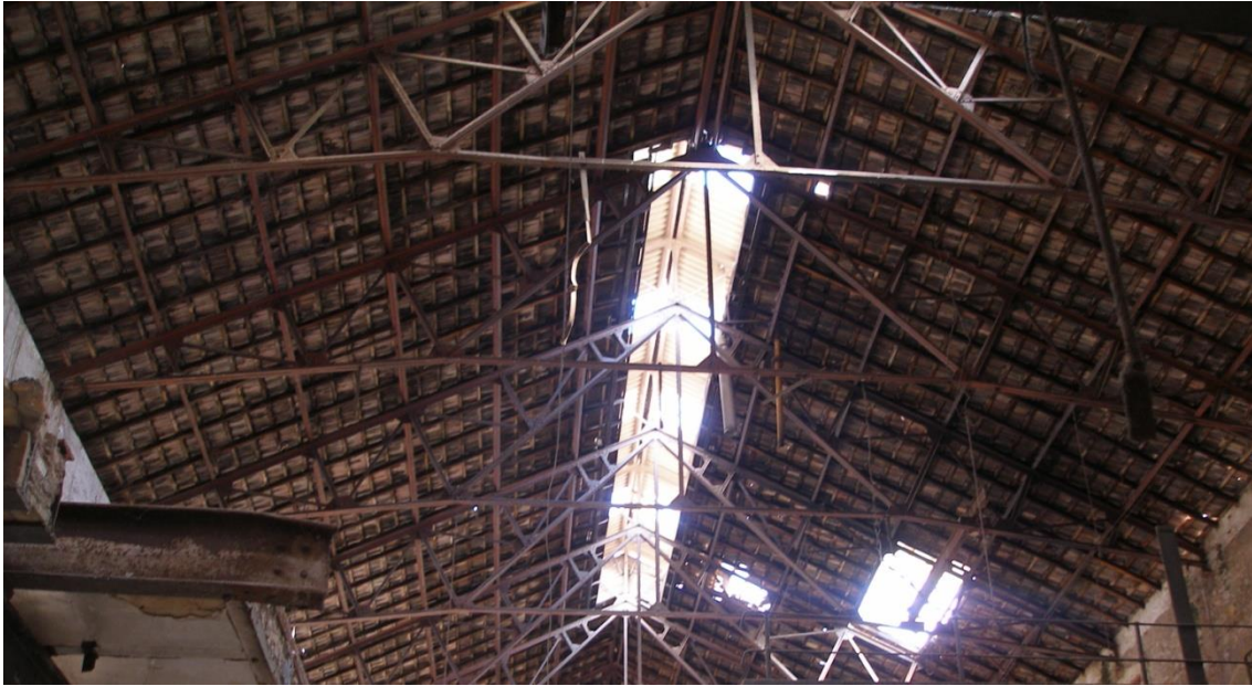
Figura 78. Estado de la cubierta metálica de la Fábrica de San Isidro en marzo de 2008. Fuente: Elaboración propia.
