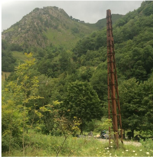
Figura 183. Apoyo en columna para la electrificación del apeadero francés de Lescun-Cette-Eygun, en la línea del Ferrocarril Transpirenaico. Fuente: Elaboración propia.
