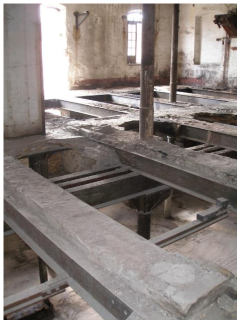
Figura 98. Refuerzo de vigas de acero laminado alrededor de huecos para alojar maquinaria industrial en dos o más niveles en la Fábrica de San Isidro. Fuente: Elaboración propia.
