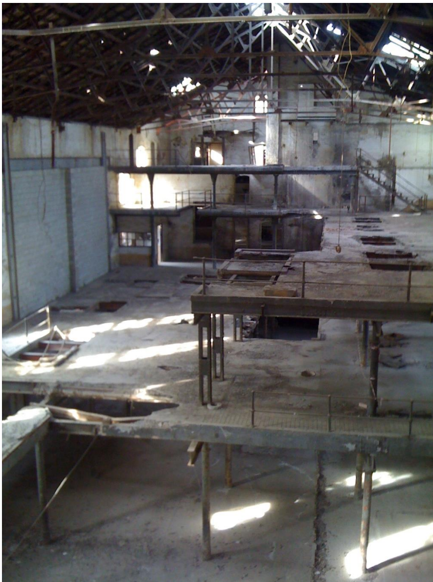
Figura 31. Estado de la Fábrica de San Isidro en julio de 2009. Fuente: Elaboración propia.
