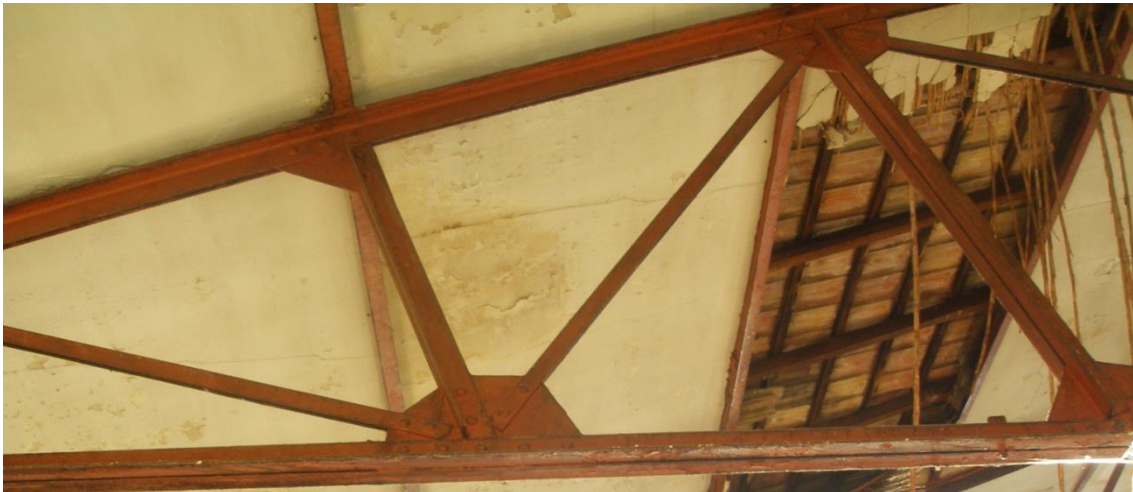
Figura 79. Cartelas de unión en las barras de las cerchas de la ampliación de la Fábrica de San Isidro. Fuente: Elaboración propia.
