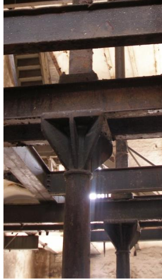
Figura 87. Columna de fundición gris en Fábrica de San Isidro. Fuente: Elaboración propia.
