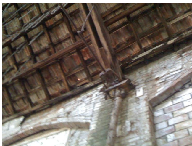
Figura 68. Estribo del tirante de acero de la cubierta de madera del Ingenio de Nuestro Señor de la Salud. Fuente: Elaboración propia.
