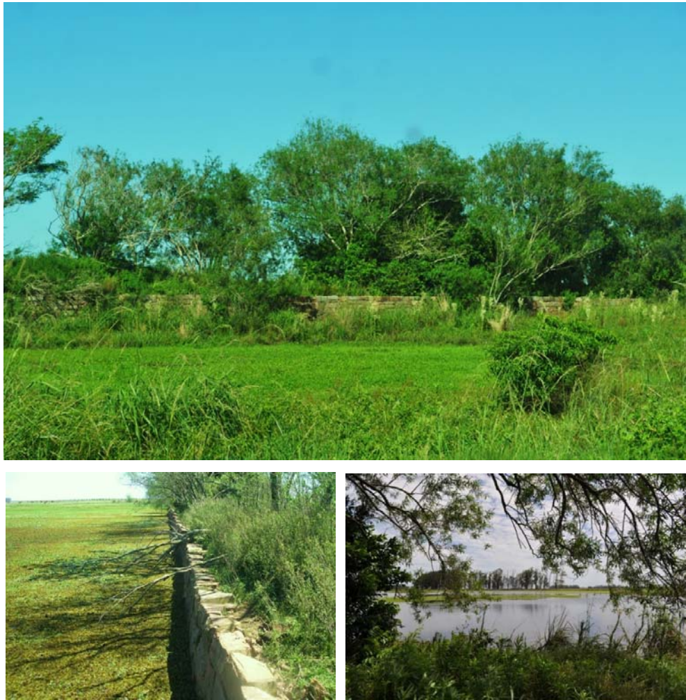
Imagen N°148: Tajamar Grande de la estancia Loma Alta . Arriba: Paramento Norte, desde RP114 [Fotog.: Soto Farías, 2010]. Abajo, izq.: Paramento Sur, contacto con el agua; der.: aspecto de la antigua reserva de agua dulce [Fotog.: Soto Farías, 2010].
