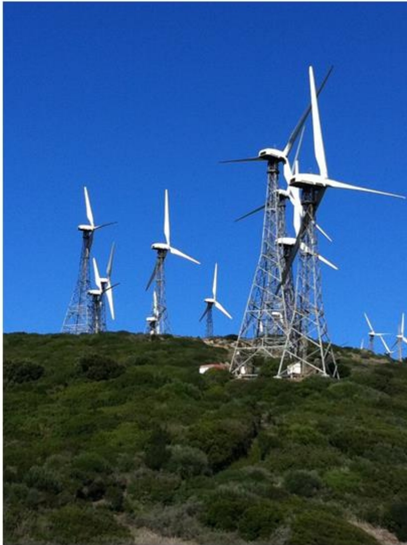
Aerogeneradores con pie en celosía. B. Pérez
