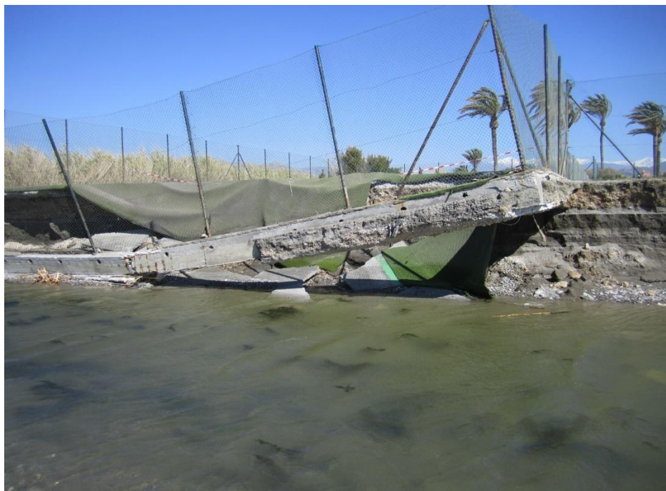
FIGURA 33: ENORMES DAÑOS SUFRIDOS EN LAS INSTALACIONES DEL HOTEL ROBINSON
