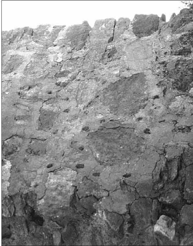
Fig. 7. Torre TNI. Detalle de la reparación (esquina inferior izquierda) y de la decoración con escorias.
