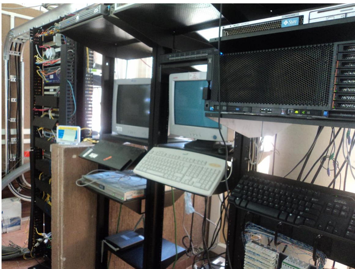
Figura 20. Equipo de telecomunicaciones.
