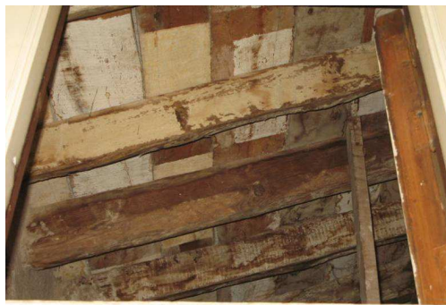
CUBIERTA VISTA DE MADERA A TRAVÉS DE LA TRAMPILLA EXISTENTE EN EL VESTÍBULO DE PLANTA SEGUNDA
