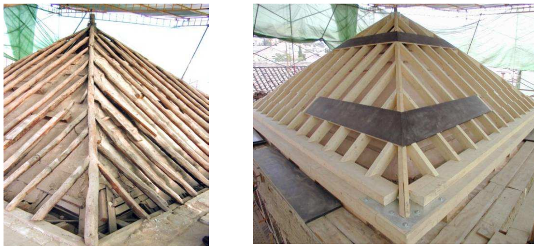
IMAGEN DE LA ESTRUCTURA DE LA CUBIERTA DE LA QUBBA ANTES Y DESPUÉS DE LA INTERVENCIÓN 631
