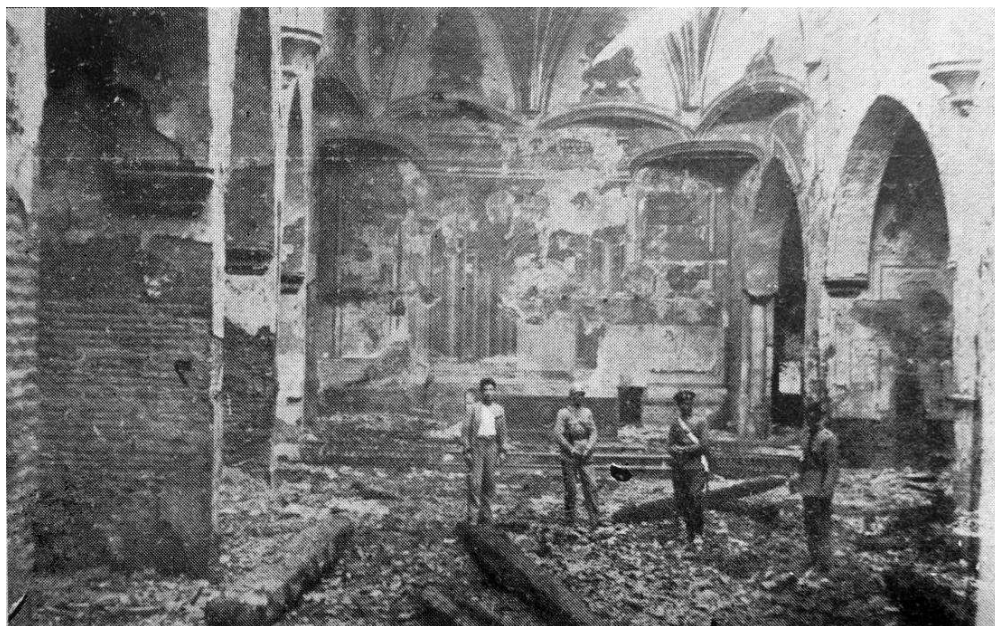
VISTA DE LA IGLESIA TRAS EL INCENDIO (TORRES MOLINA, 1932). (LA HORMIGA DE ORO Nº 33)
