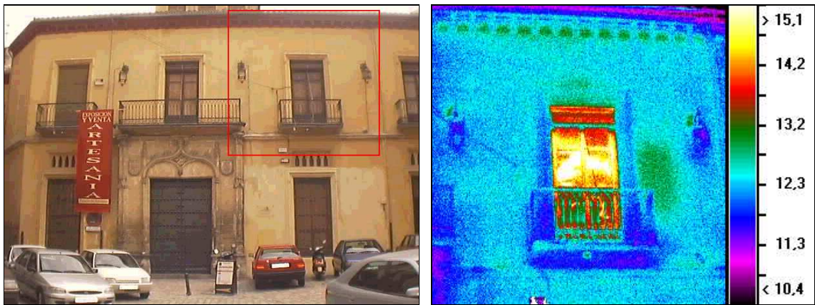
TERMOGRAFÍA DE LA FACHADA DEL PALACIO DE ABRANTES (VORSEVI S.A.)
