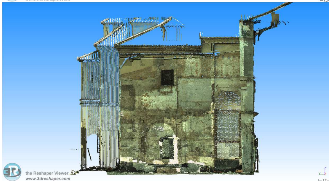
LEVANTAMIENTO MEDIANTE ESCÁNER LÁSER DE LAS FACHADAS POSTERIORES DEL HOSPITAL DE SAN JUAN DE DIOS. NUBE DE PUNTOS. (GRAF: JUAN FCO. REINOSO, SMLAB. PROYECTO: FERNANDO ACALE)
