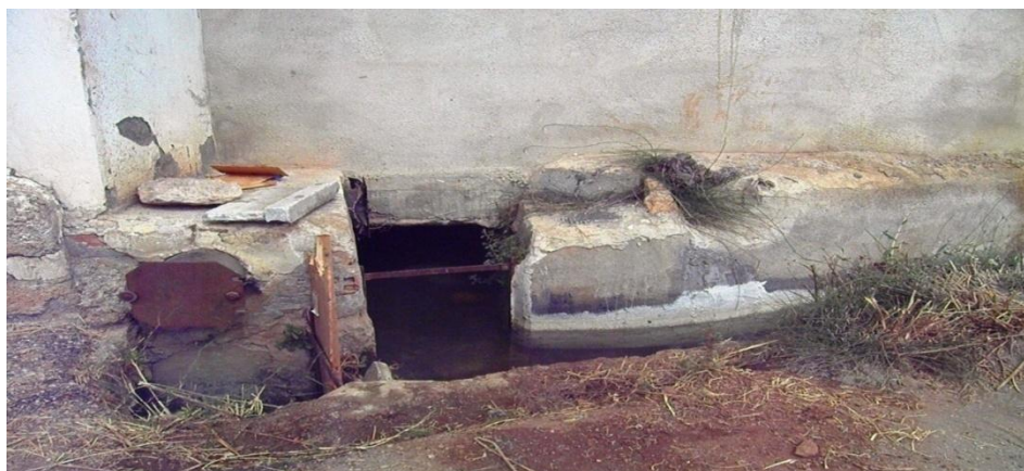
Ilustración 133: Partidor de la Acequia de Dúrcal en Cozvíjar
