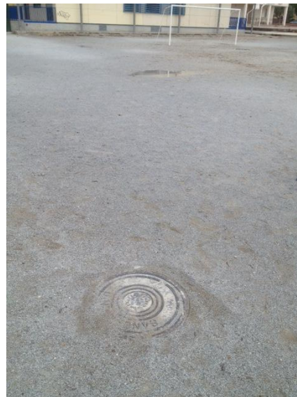
Imagen 20. Arqueta dentro de la pista.
