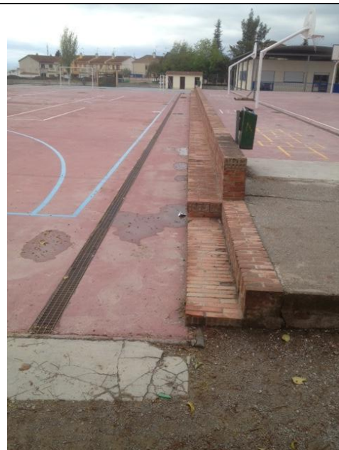
Imagen 32. Ausencia de distancia de seguridad.
