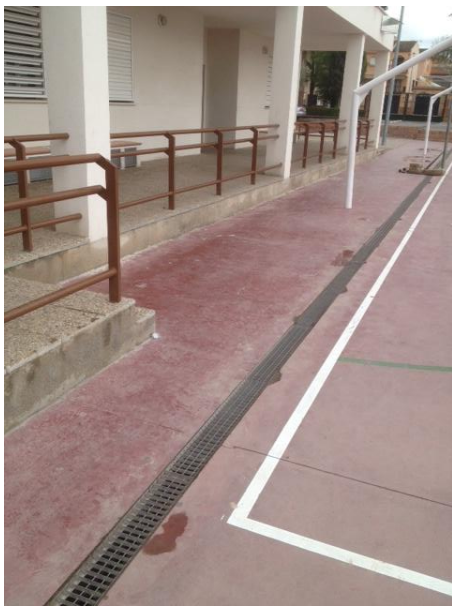
Imagen 7. Zonas de acceso a espacios exteriores. Escalones cercanos a la pista, sin guardar una distancia de seguridad.
