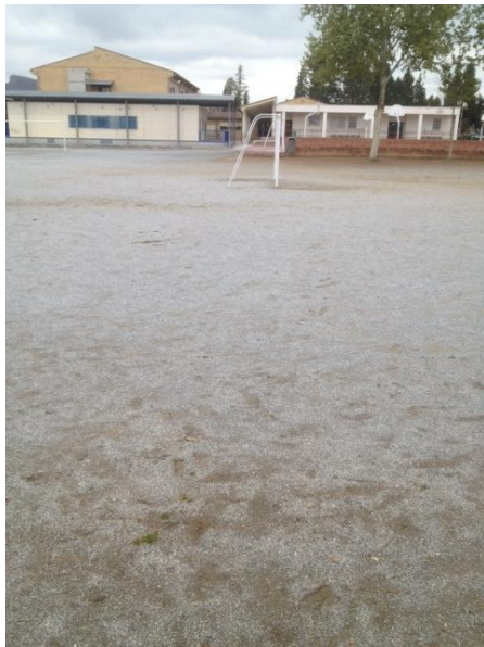
Imagen 16. Ausencia de líneas divisorias.
