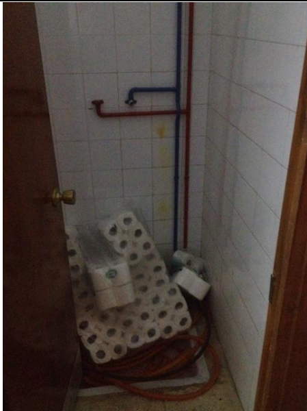
Imagen 43. Vestuarios. Vestuarios utilizados como almacén.
