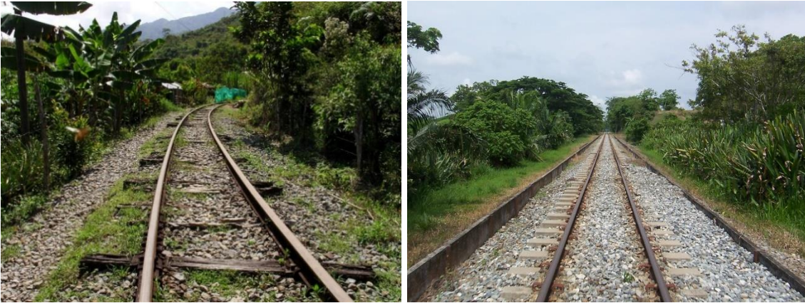
Figura No. 4-5: Izq. Corredor férreo y vía original con enriado y traviesas en madera de comino en la zona de La Quebra. Foto del autor- Der. Corredor férreo rehabilitado con nuevo enriado y traviesas en hormigón prefabricadas. Trayecto Puerto Berrío- Grecia. Fotografías del autor
