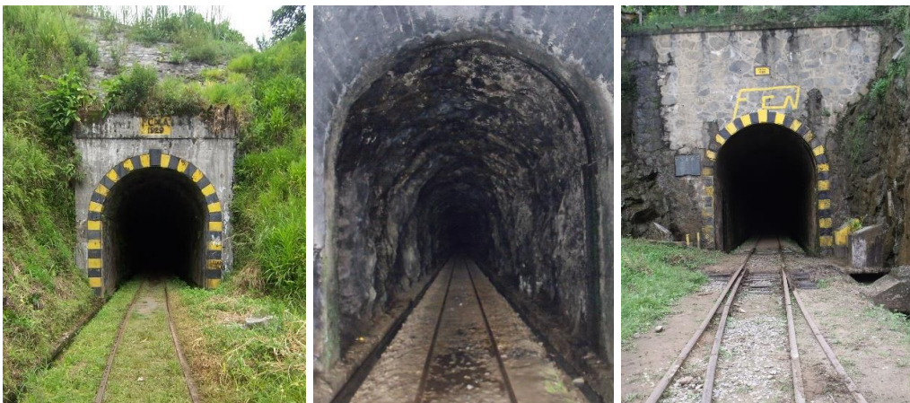
Figura No. 4-8: Superior- Bocas de túnel de La Quebra en las estaciones de Santiago y El Limón. Fotografía del autor. Inferior: Fotografía retocada de la boca del túnel por Santiago en su etapa de construcción. Fuente: Archivo fotográfico de Antioquia, Biblioteca Pública Piloto. Ref. BPP-F-015-0345.
