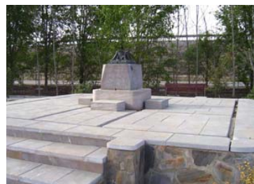
2006 04. Plataforma, primer plano oblicuo con una losa desprendida.
