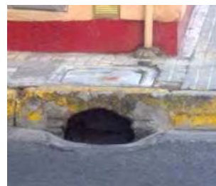
Img. 12. 35 Boca de desagüe para aguas pluviales.. Foto: A. Salas.
