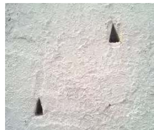
Img. 12. 34 1999 Agujeros triangulares en un muro. Archidona. Foto: A. Salas.
