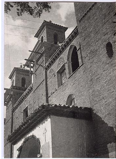
Ilustración 06. Fachada norte de la iglesia de San Félix en el proceso de restauración, 1961. Archivo de la empresa Tricás.
