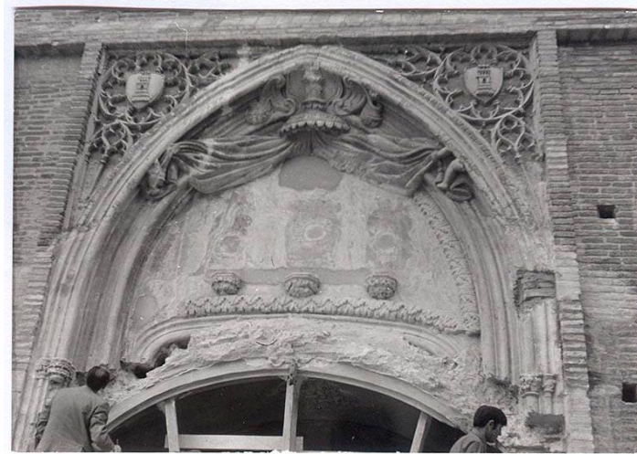
Link 16. Detalle del descubrimiento de la portada gótica original, mayo 1972. Archivo de la empresa Tricás.
