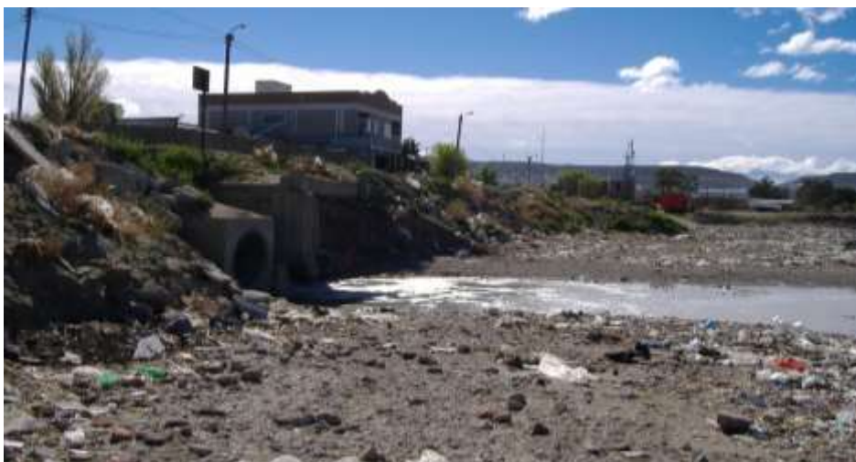
Imagen 29. Parada 7. Aguas residuales.
