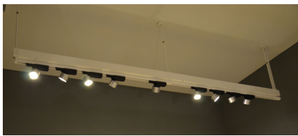
Carril de iluminación
