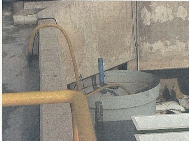
Fig.VIII.3.-Bomba de entrada de caudal al depósito sumergida en el canal de salida del desarenador y depósito de regulación a plantas experimentales.
