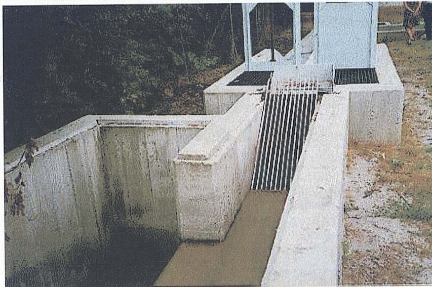
Fig.VI.18.- Pretratamiento: Aliviadero de seguridad y reja de gruesos de la ED de Jayena.
