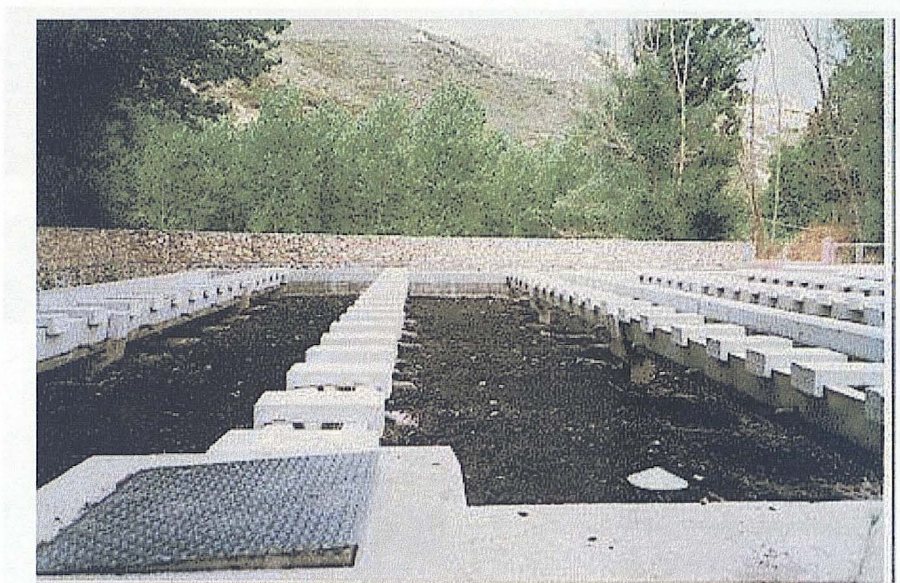
Fig.VI.22.- Lecho de turba preparado para funcionar en la ED de Jayena.
