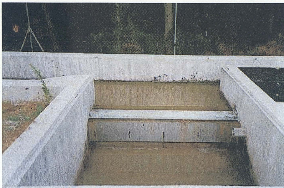
Fig.VI.20.- Pretratamiento: Tubo de recogida de grasas tipo "Skimmer", de la ED de Jayena.
