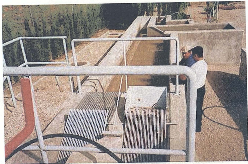
Fig.VI.8.- Pretratamiento: Reja de finos y desarenador-desengrasador de la ED de Torrecardela.
