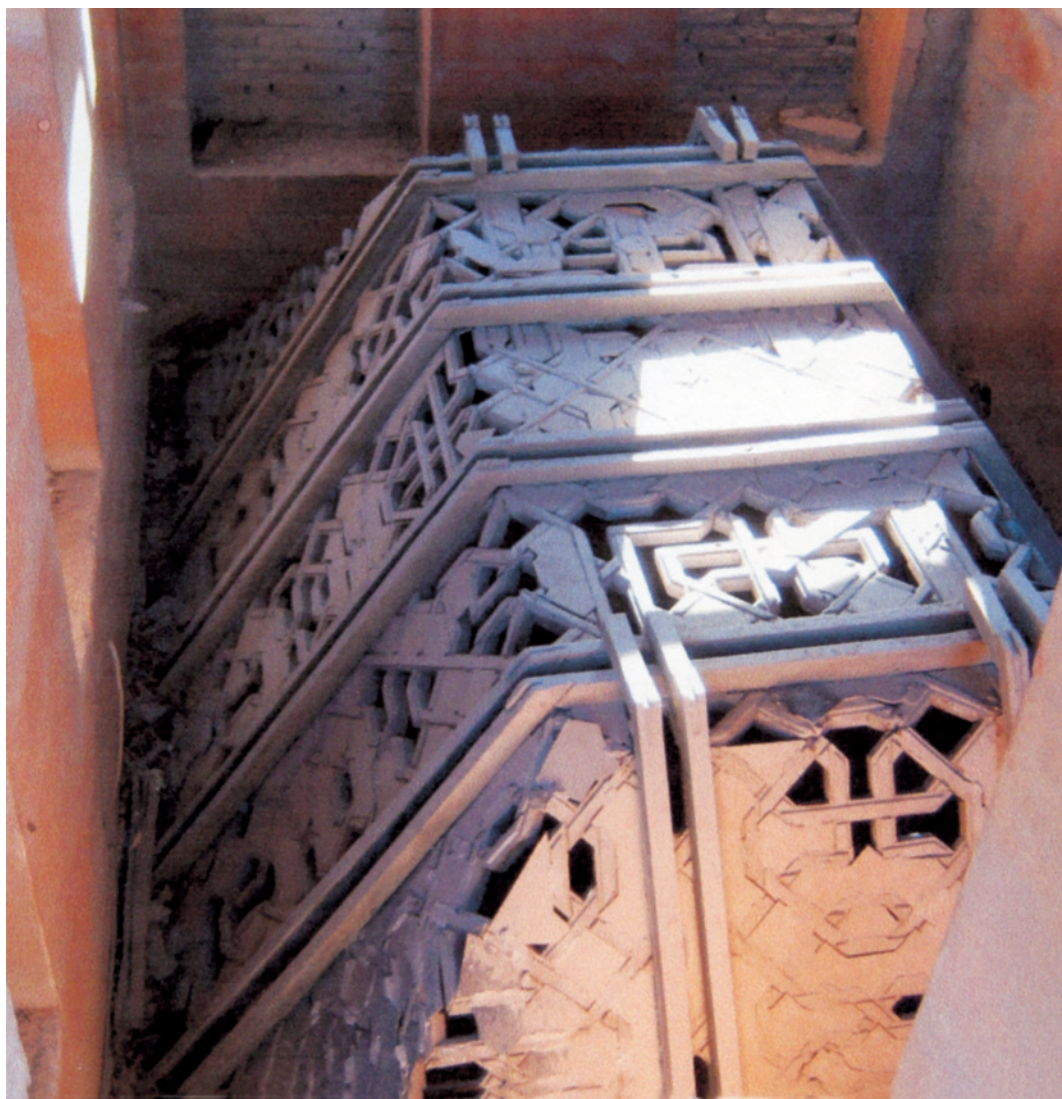
Fig. 16. Trasdós de la armadura apeinazada, con su refuerzo de 1853 y estado de conservación.
