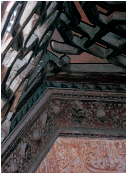
Fig. 12. Detalle de un ángulo de la armadura apeinazada con los peinazos rotos y los vidrios perdidos. El arrocabe tiene piñas y palmetas talladas en alto relieve y adosadas mediante pequeños clavos.
