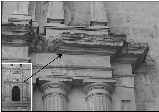
Figura 7. Daños por pérdidas de material en una moldura de la portada del Monasterio de San Jerónimo (Granada).
