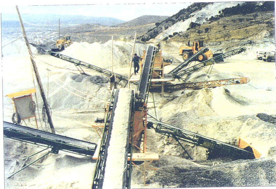
Figura 3.6. Vista de la tolva de alimentación. De la primera criba se obtiene arena y el rechazo es transportado a la segunda criba donde existen varias cintas de salida.
