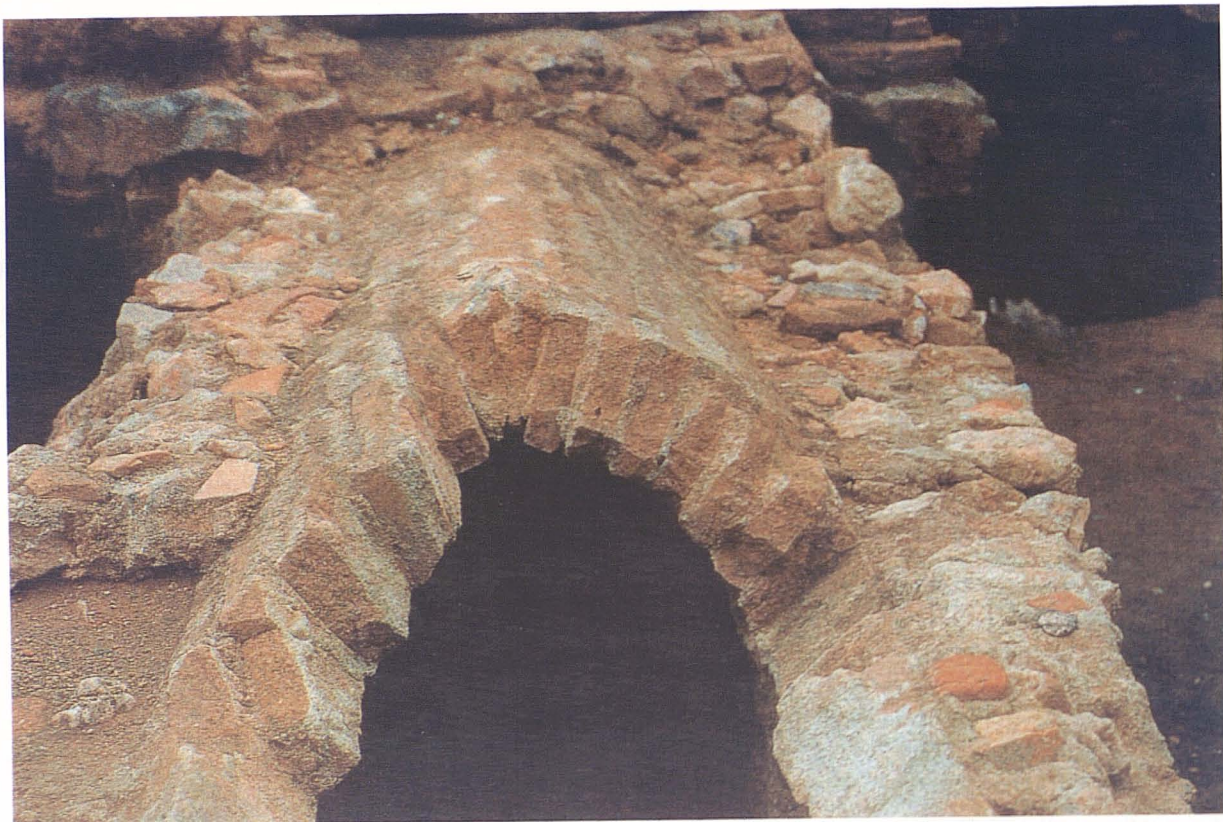
Detalle de la bóveda de una alcantarilla de Badalona del siglo XVIII
