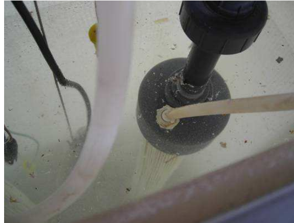
Figura 13. Módulo de membrana de ultrafiltración
