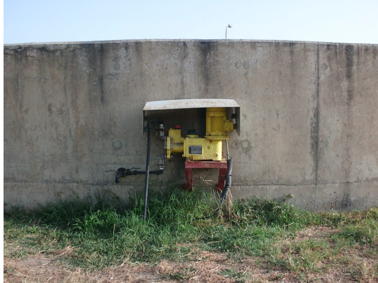
Figura 20. Bomba de alimentación planta piloto
