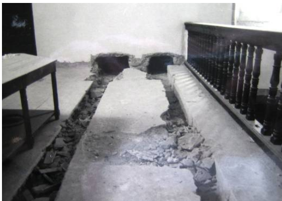
Fig.358. Iglesia de San Juan Evangelista. Calicatas abiertas para colocación de vigas. AGA, IDD (3)115 caja 26/01317.
