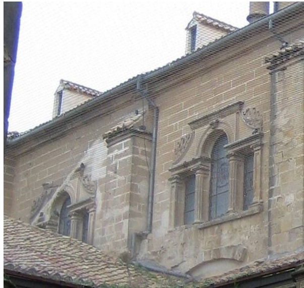
Fig.423. Serliana descubierta una vez realizada la obra. Se observan las marcas de la antigua cubierta y la nula restitución de elementos decorativos deteriorados.
