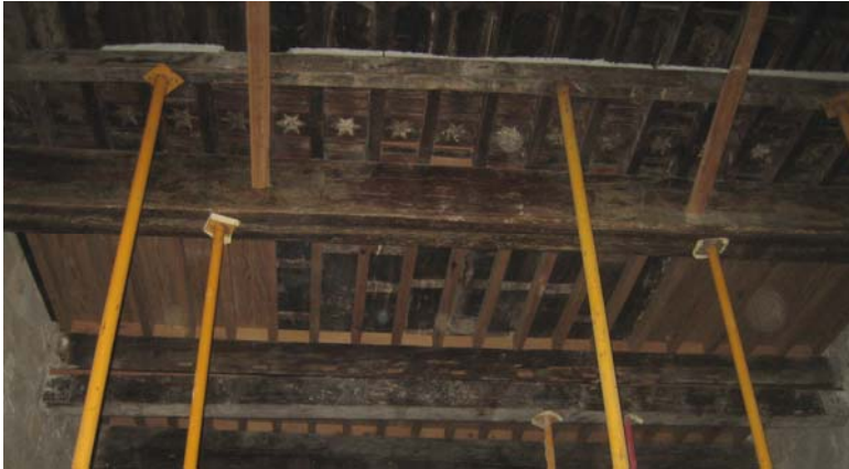
Fig.415. Casas Consistoriales Altas. Alfarje -techo de planta baja- con sustitución de elementos deteriorados por otros del mismo material. Estado actual.
