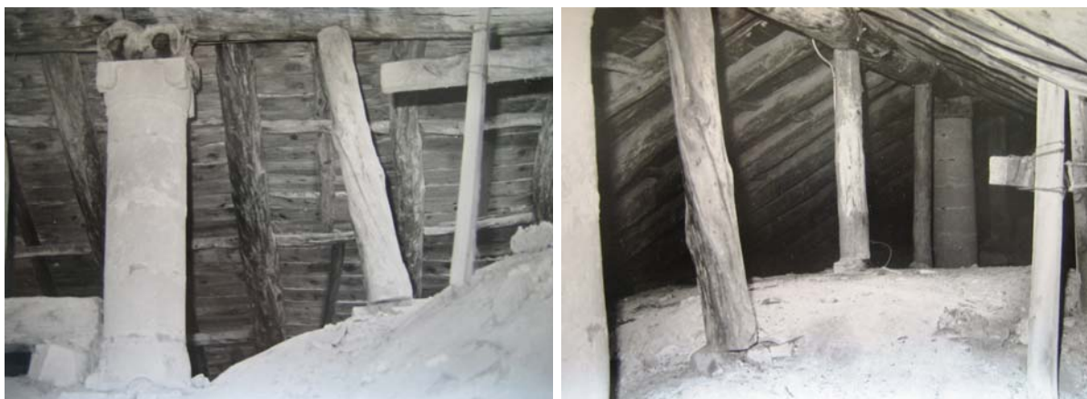
Figs. 242 y 243. Iglesia de San Pablo. Estado de la cubierta con diversos elementos como apeos apoyando sobre las bóvedas. Entre ellos un pilar cuyo capitel es igual a los de la iglesia del Salvador. AAAB.
