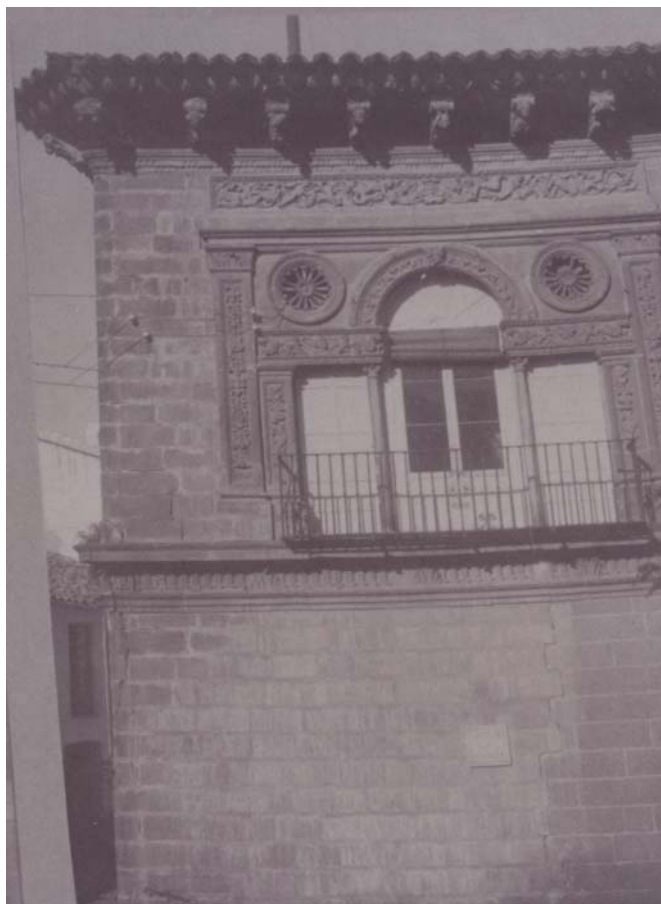
Fig.32. Esquina del edificio del Ayuntamiento en la que se observa la grieta, ya reparada en ocasiones anteriores. Catalogo de Monumentos de la provincia de Jaén . 1913-15. BLIEG.
