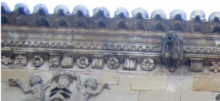
Fig.307. Detalle de la cornisa "nueva", igual a la original pero con motivos florales distintos a los existentes.
