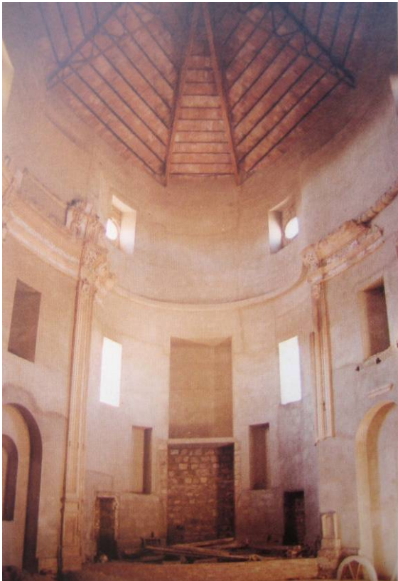
Fig.403. Iglesia de los Trinitarios Descalzos. Estado del interior antes de la intervención de Martín Clabo y Padilla. AEMC.
