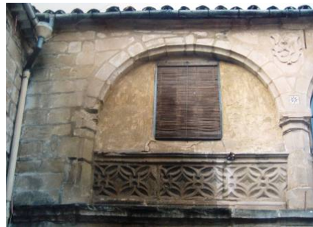
Figs.207 y 208. Desplome y apuntalamiento de la galería este. AELL.
