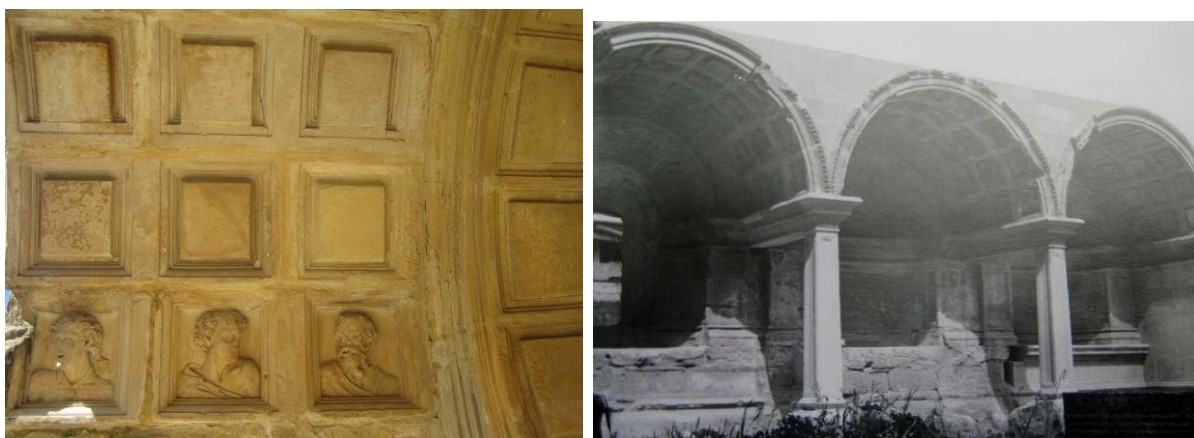
Figs.166 y 167. Detalle de casetones restituidos sin decoración y vista general de los tres arcos del altar mayor terminados, con la restitución de zócalos, molduras y casetones con la decoración muy simplificada. AELL.
