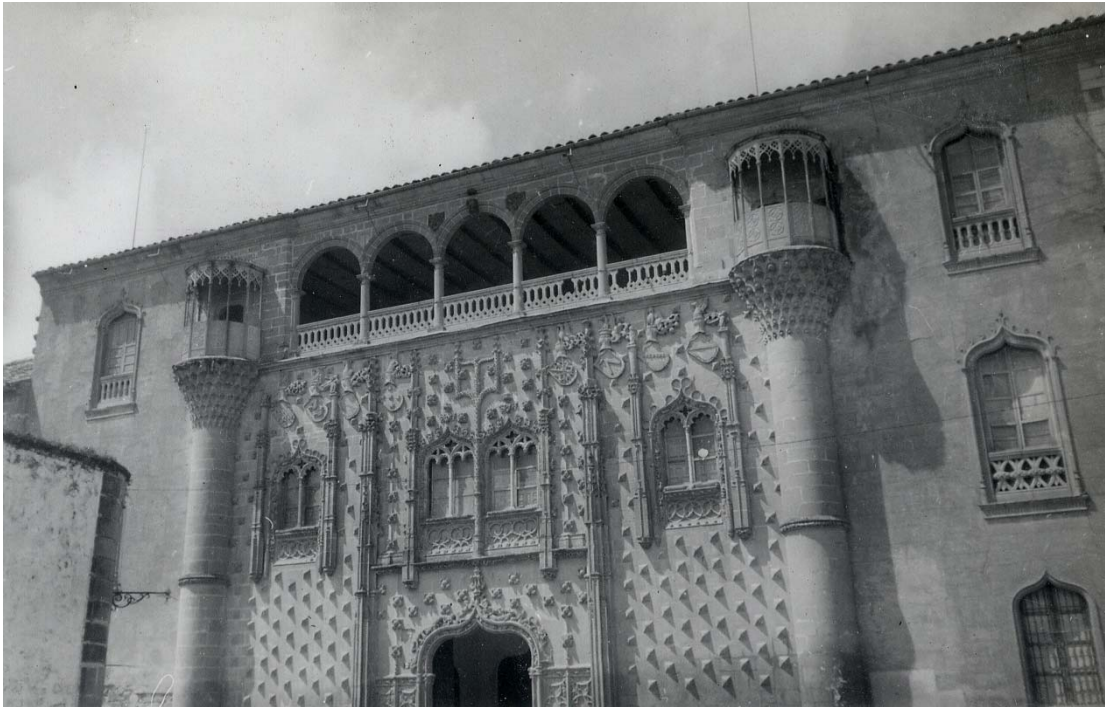
Fig.65. Fachada con los templetes y la balastrada de la galería deteriorados, antes de la intervención de Prieto-Moreno. 1941. AGA, IDD (3)5, caja 51/11279.
