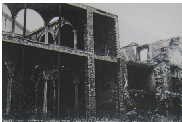
Fig.363. Estructura de atado del claustro de Santa Catalina. AHPJ, Comisiones de Patrimonio 1993 caja 61133.
