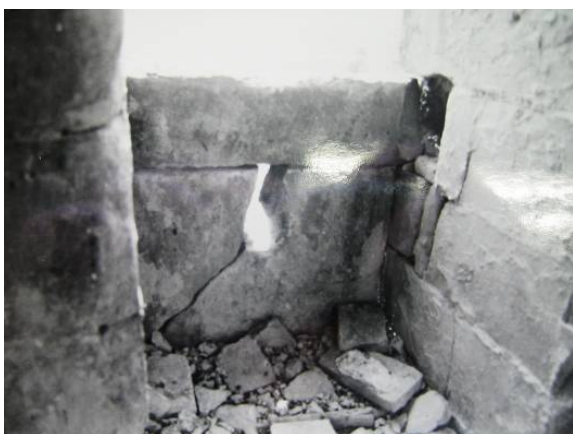
Fig.360. Estado del pretil de piedra antes de la intervención. AGA, IDD (3)115 caja 26/01317.
