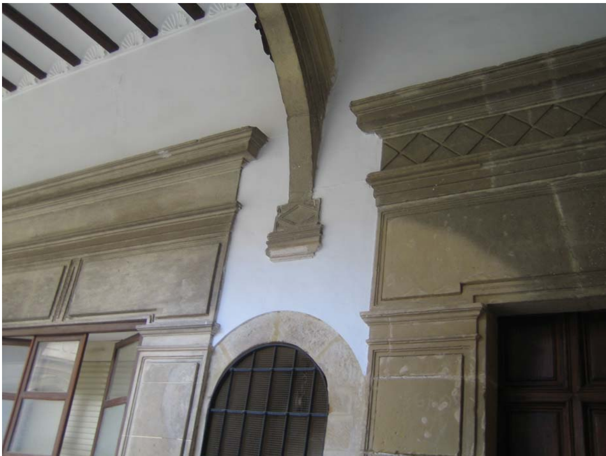
Fig.61. Universidad. Hueco original a la derecha en piedra y hueco de nueva factura a la izquierda, con recercado en mortero imitando la piedra, en la que no se reproduce la decoración superior.
