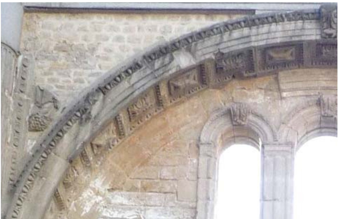
Fig.38. Ruinas de San Francisco. Estado actual. Se observa el muro de mampostería, el sillar colocado para cerrar el hueco, la pilastra incompleta y la ausencia de decoración en los nuevos elementos.
