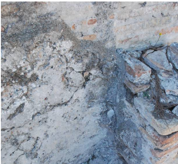
Fig. 408. Bordes del intonaco con morteros nuevos en el zócalo del ninfeo del decumanus de Ostia Antica.
