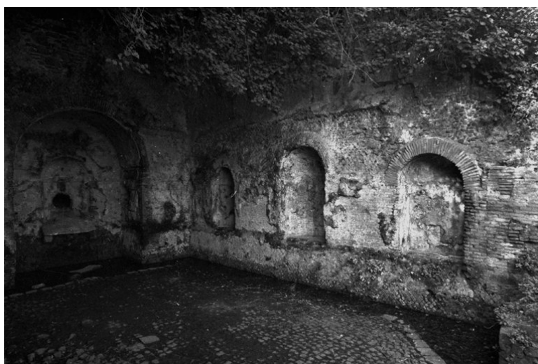
Fig. 634. Imágenes del estado del ninfeo antes de la intervención de 1999. 1223
