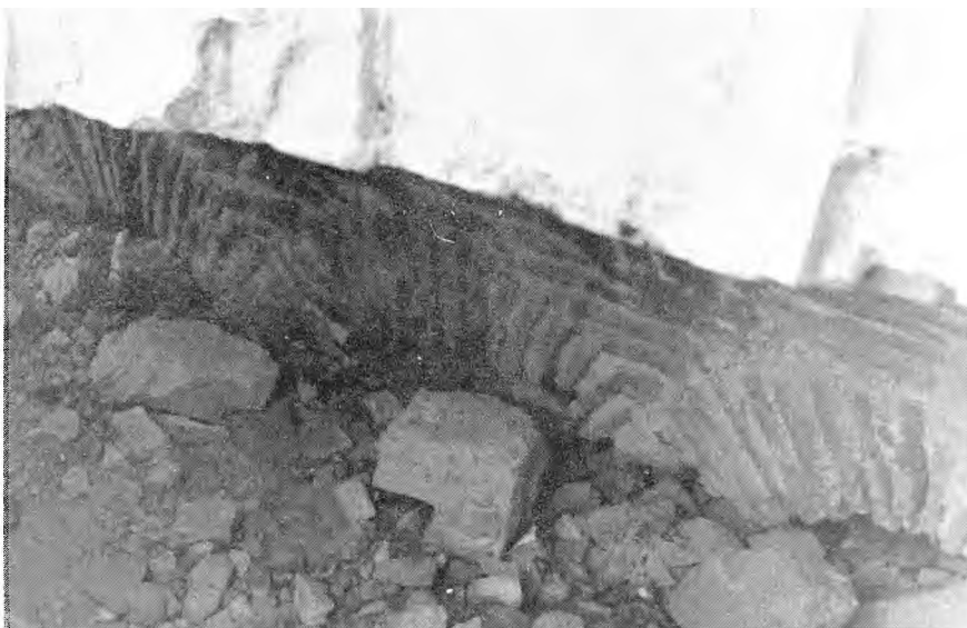
Fotos 7 y 8.-El aljibe adosado al muro de Levante, donde es de destacar el empleo del ladrillo ocre oscuro y el mortero de cal y arena, así como el estucado rojo que recubre el interior, cubierto éste con bóveda de medio cañón.
