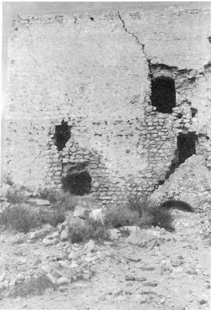
Foto 3.-Vista parcial de la fachada meridional de la torre, desde el espacio que le precede. Frente a ella, la escalinata de acceso a la entrada de la misma. Obsérvese también la mezcla de ladrillo y piedra en el paramento.
