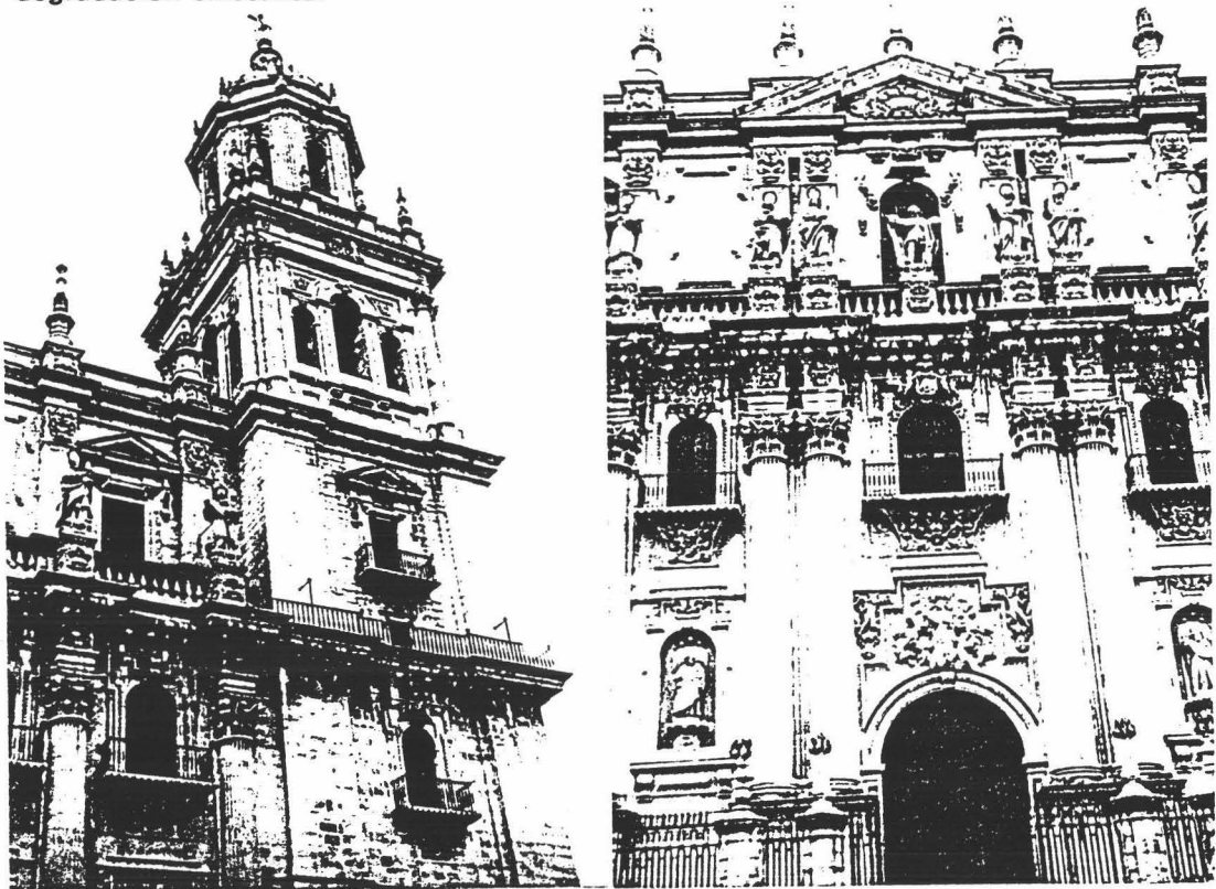
Fig. III-22. Costras Negras existentes en la Catedral de Jaén, desarrolladas sobre materiales calizo micríticos. (abajo la cornisa)
