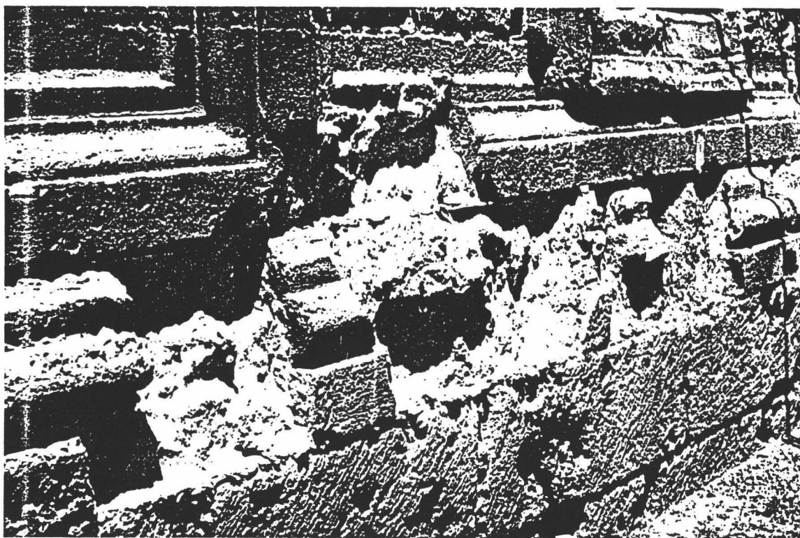
Fig. III-7. Arenización: aspecto general (a); y detalle (b); de sillares y pináculos de la Catedral de Granada arenizados; Torre (c).
