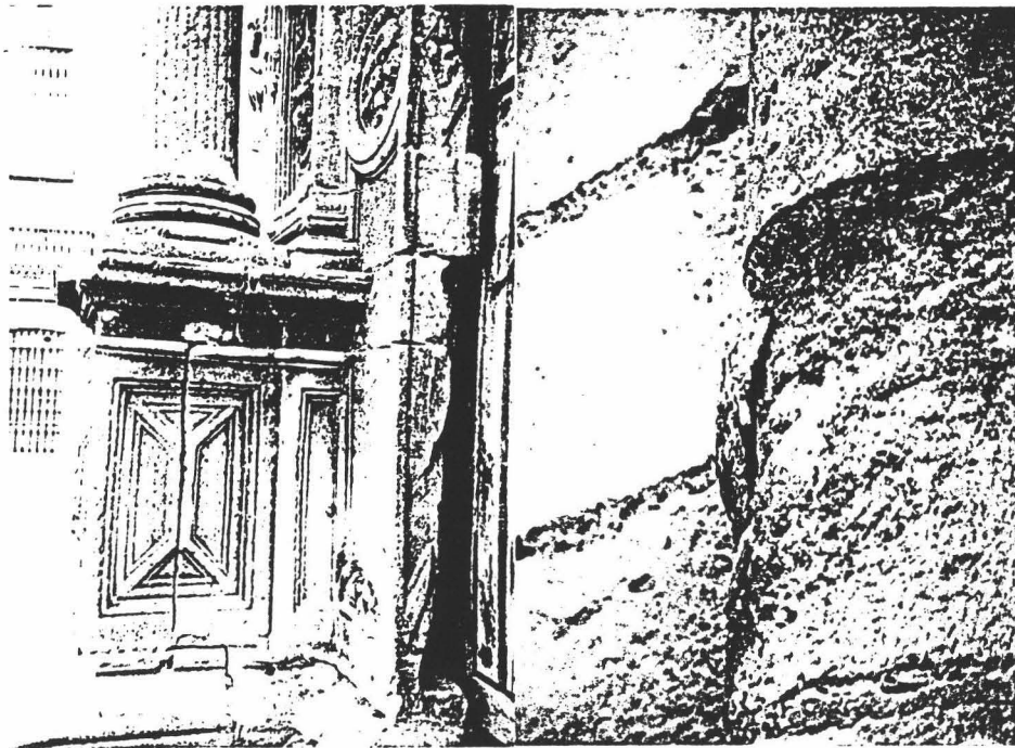
Fig. III-12. Ampollas desarrolladas en las Columnas de la Portada del Perdón de la Catedral de Granada.
