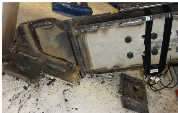
Figura 8.4: Detalle de la fijación del disipador WPD a la chapa de sujeción entre los nudos viga-pilar de la estructura principal del edificio
