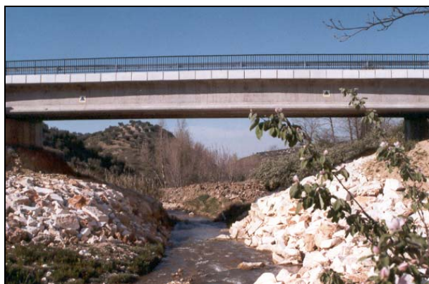
Detalle de Estructura sobre río en Variante de Almedinilla. Parque Natural de las Subbéticas Cordobesas – Córdoba. La misma queda perfectamente integrada en el entorno hasta el punto que hay que situarse en el propio río para poder apreciarla.
