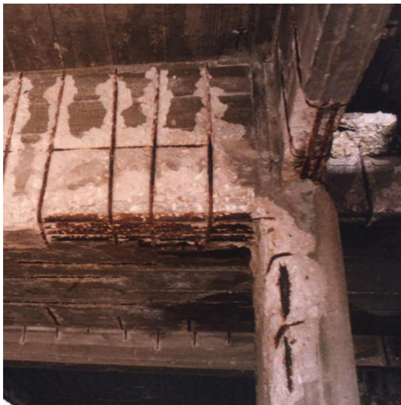
Fig. 2. Hormigón armado deteriorado
