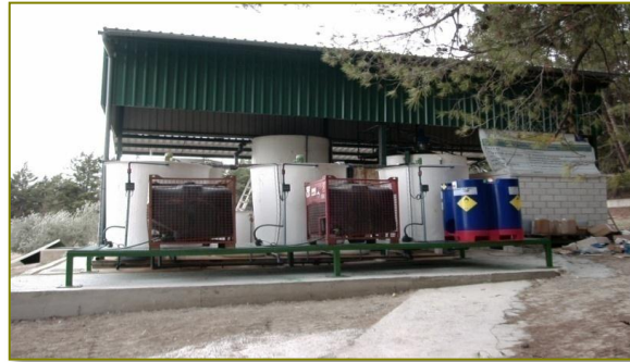
Fig. 1.III.4. Planta de depuración de aguas residuales de lavado en Baeza.
