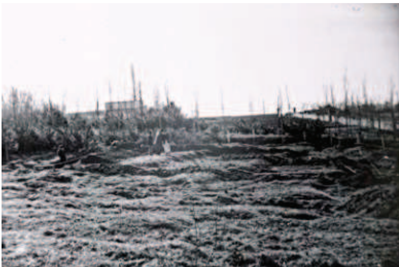
Solar donde se construye la casa Oswald en Ciudad Puerta de Hierro. 14-02-1952
