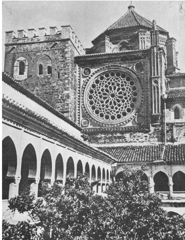
Monasterio de Guadalupe, restauración del rosetón meridional, estado previo (arriba) y restaurado (abajo)
