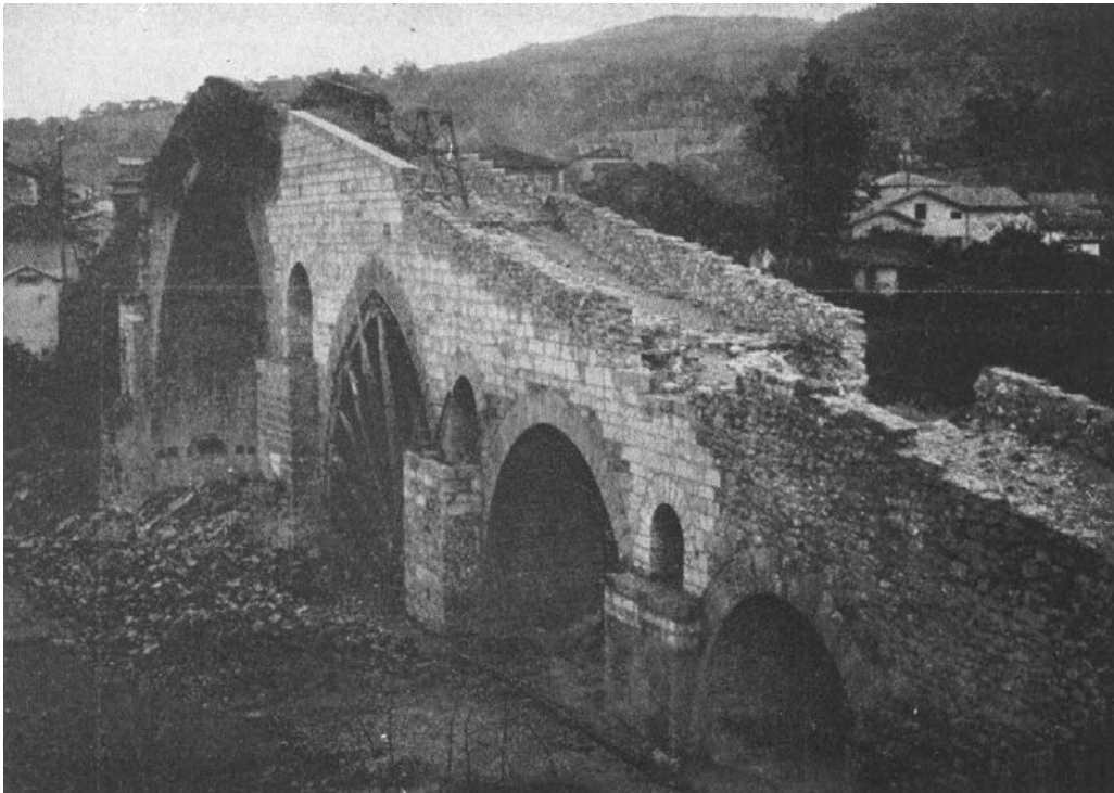
El puente de cangas de Onis durante las obras de restauración Foto Luis Menéndez-Pidal, 1941
