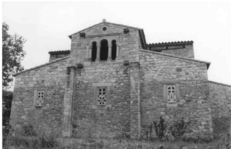
Ábside reconstruido con los faldones en su estado final. Foto del autor
