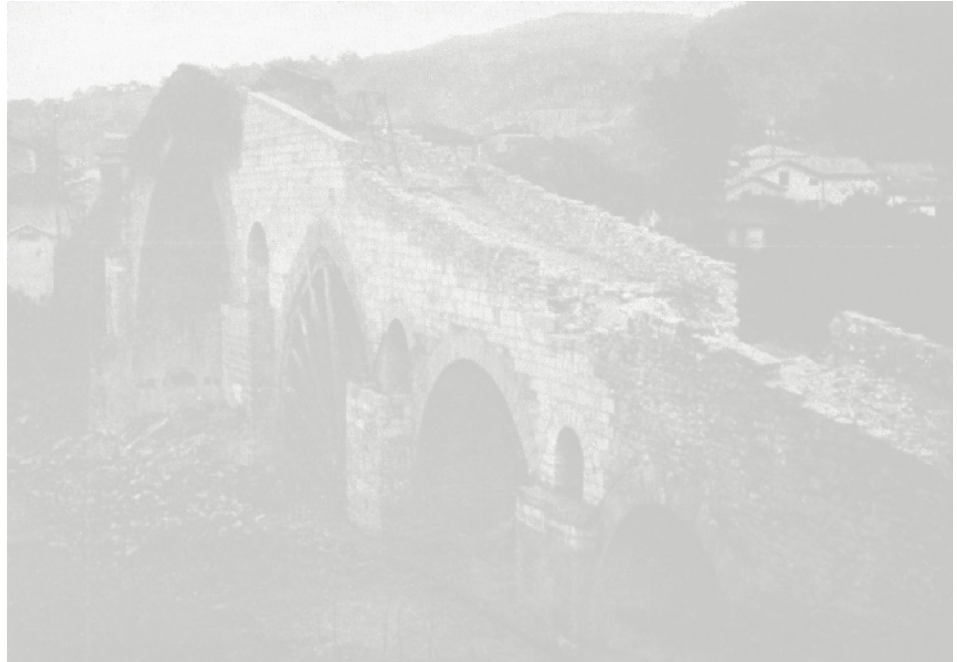
El puente de Cangas de Onís durante los trabajos de restauración, véase la discriminación entre fábricas añadidas y originales. Foto Luis Menéndez-Pidal, 1942
