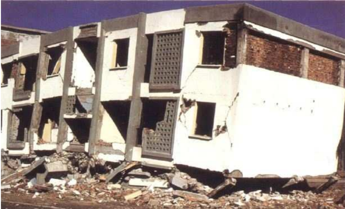
Figura 3.2: Fallo por “planta débil”. Terremoto de Al Asnam (Algeria) de 1980.
